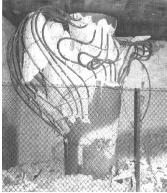
Figura 1.7. Daño en pilas, desintegración del hormigón por refuerzo cortante transversal escaso. Paso a desnivel La Cienega-Venice, autopista de Santa Mónica. (Priestley et al. 1994).
