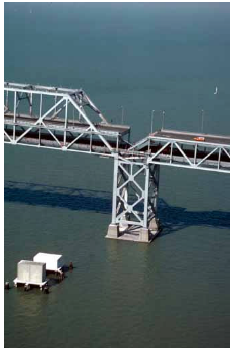
Figura 1.1. El colapso de una sección del Bay Bridge produjo fuertes pérdidas económicas (EQE International 1979) .
