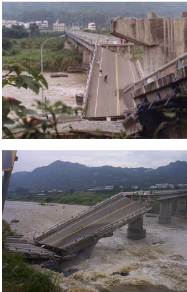
Figura 1.12. Condición del puente Shi-wei después del sismo. La acción sísmica produjo la torsión de la pila 2 y el subsiguiente colapso de tres vanos. (Buckle et al. 1999)
