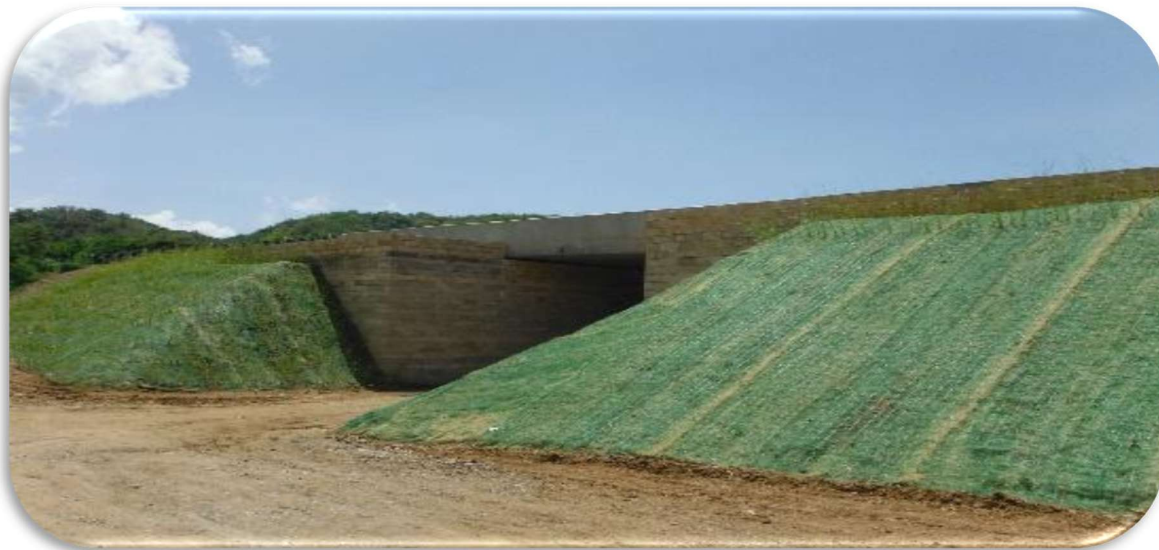
Figura 13: El Suelo Reforzado Geosintético (GRS) completado en los puentes 1121 y 1122 en la carretera PR-2 en Yauco, Puerto Rico.
