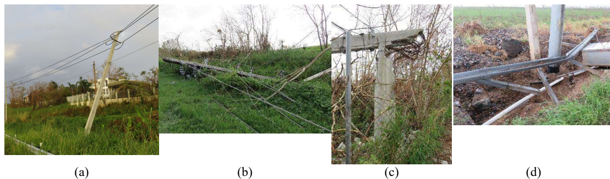
Figura 4: Ejemplos de fallas de postes en la región oeste – (a) falla en la fundación, (b) efecto en cadena por caída de vegetación, (c) poste de esquina tirado por vegetación sobre cables, (d) erosión en la base por inundación de río.
