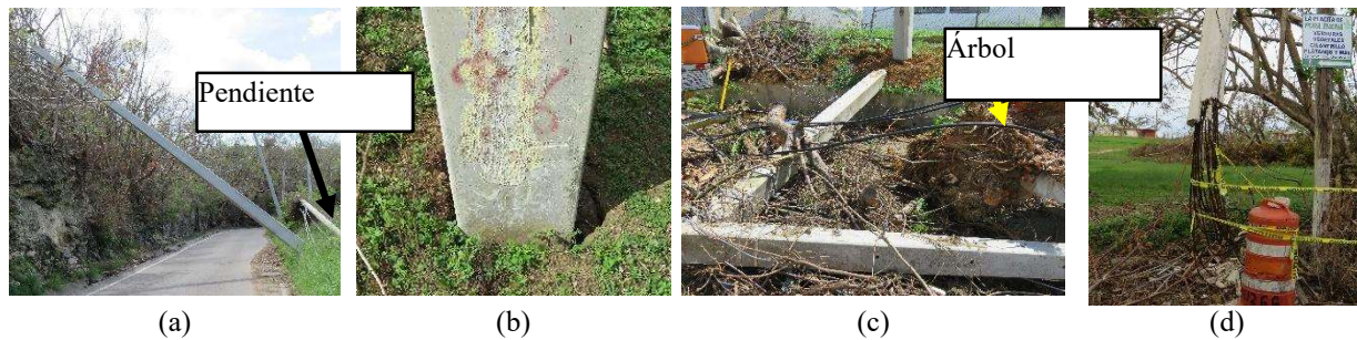
Figura 5: Ejemplos de fallas de postes en la región Noroeste – (a) falla en fundación, (b) separación del suelo en la cimentación debido a la oscilación por viento, (c) falla causada por vegetación (árbol), y (d) deterioración por oxidación en el refuerzo.
