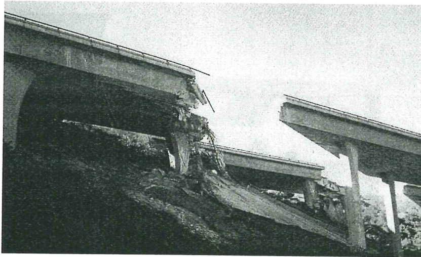
Figura 1.7. Colapso de las secciones del extremo Norte del I-5 en el Cavin Cayon, (Priestley et al. , 1994).
