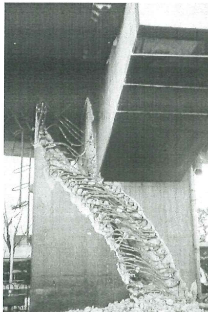
Figura 1.25. Una columna de hormigón armado fallo debido a una fuerte fuerza cortante en el Hanshin Expressway en Mikage, Higashi - Nada Ward, (Architectural Institute of Japan Society of Civil Engineers).
