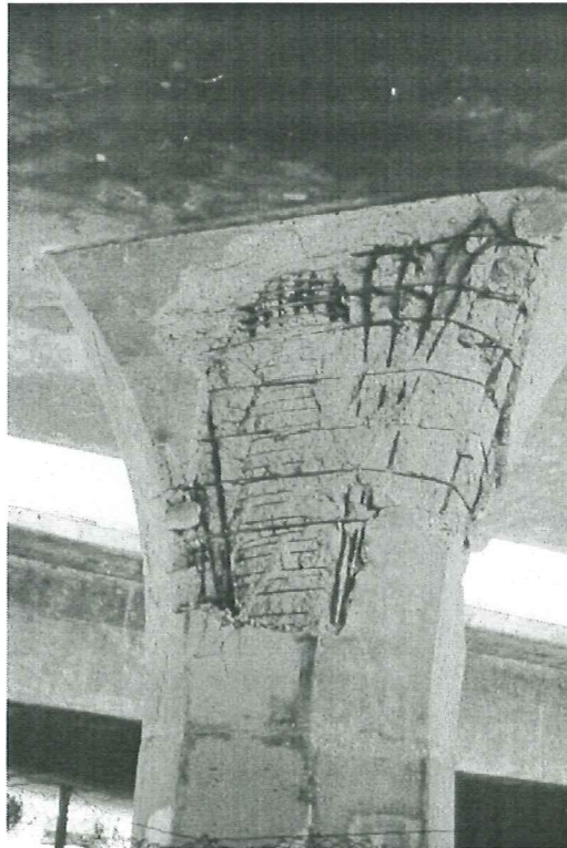
Figura 1.13. Fallo por flexión-cortante en la zona de anchura variable, (Priestley et al. , 1994).
