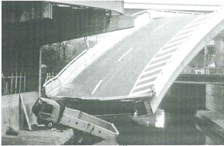
Figura 1.20. La parte superior de la columna de hormigón armado fallo por compresión causando la caída de la viga, Nagata Ward, (Architectural Institute of Japan Society of Civil Engineers).
