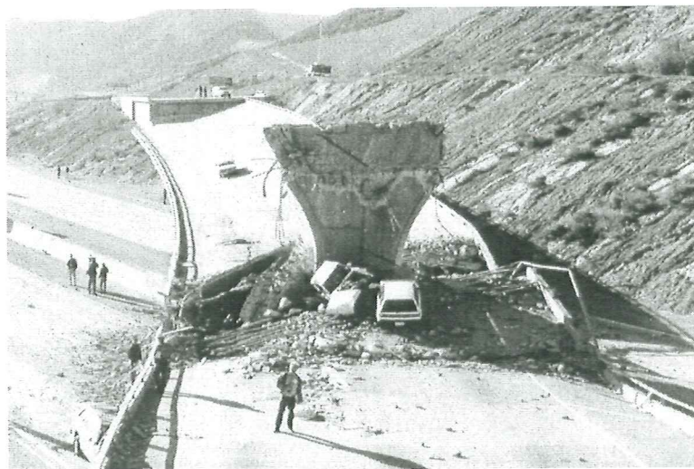
Figura 1.10. Estado del puente pasado el sismo, (Priestley et al. , 1994).
