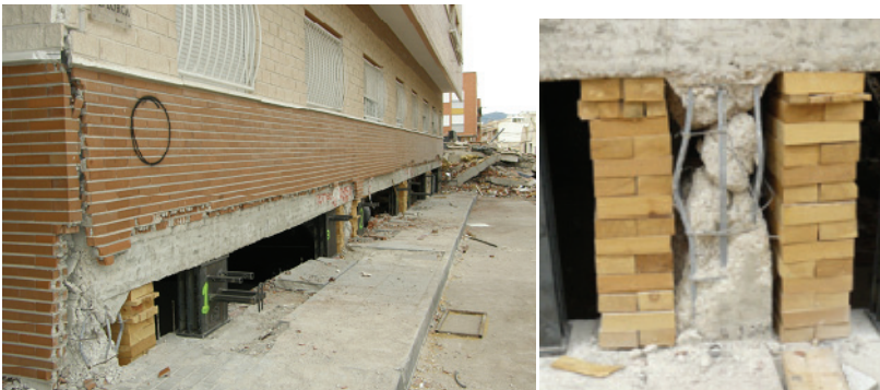
Fig. 4. Daños en otro edificio con múltiples pilares cortos.
