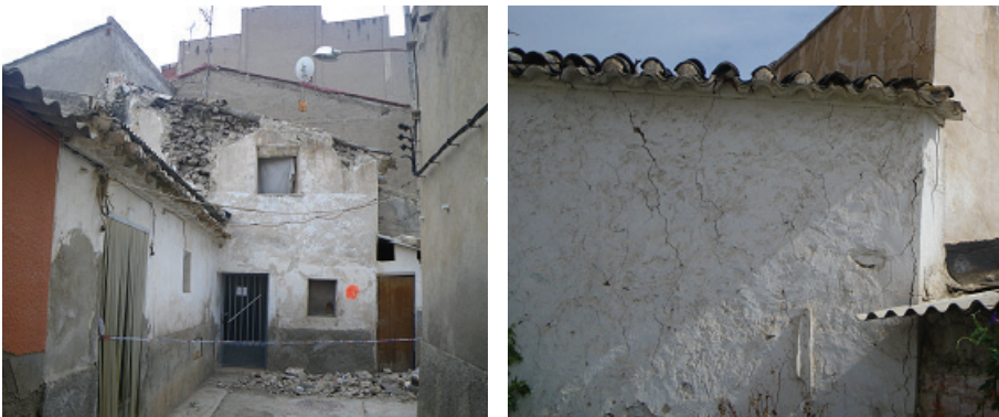
Fig. 12. Daños en las estructuras de mampostería no reforzada.
