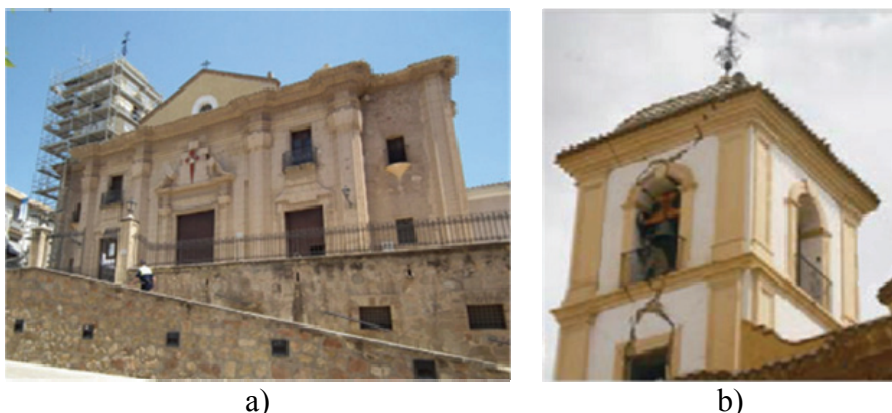
Fig. 19. a) Fachada de la iglesia de Santiago y daños en su torre. b) torre del campanario pocos días después del terremoto (IGME, 2011)
