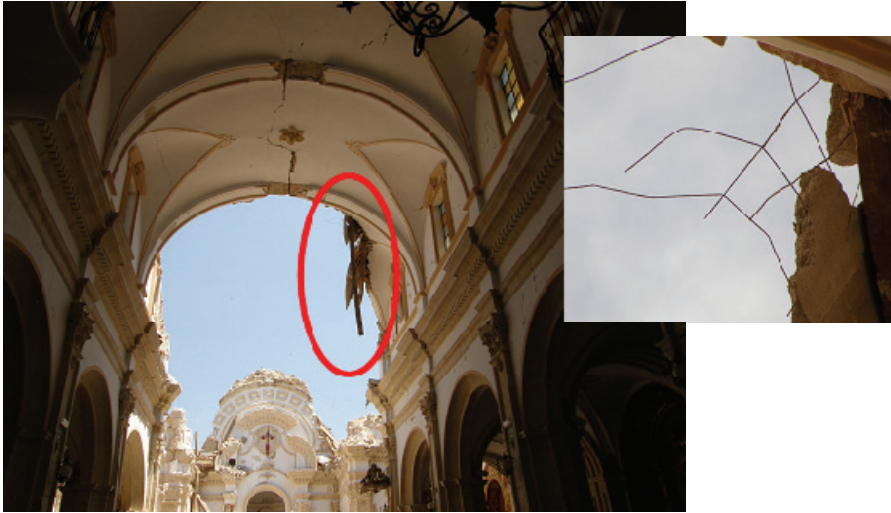
Fig. 20. Colapso de la cúpula y del crucero de la iglesia de Santiago y detalle de mallas de refuerzo
