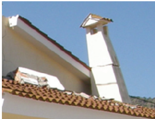
Fig. 15. Chimenea dañada por el terremoto en casa residencial
