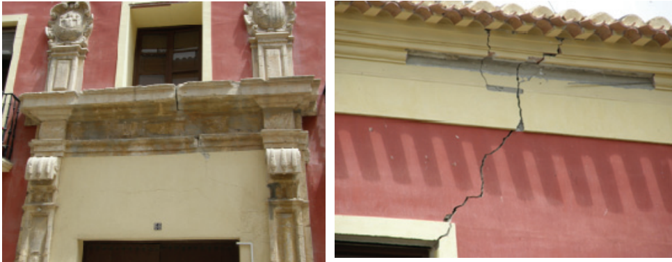
Fig. 11. Daños en las estructuras de mampostería no reforzada.
