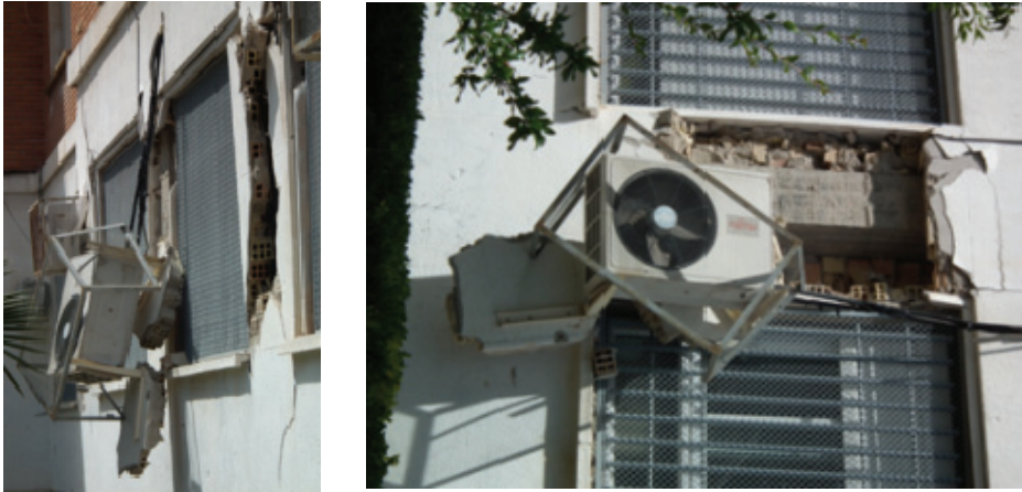
Fig. 18. Aparatos de aire acondicionado anclados a la fachada, después del terremoto.
