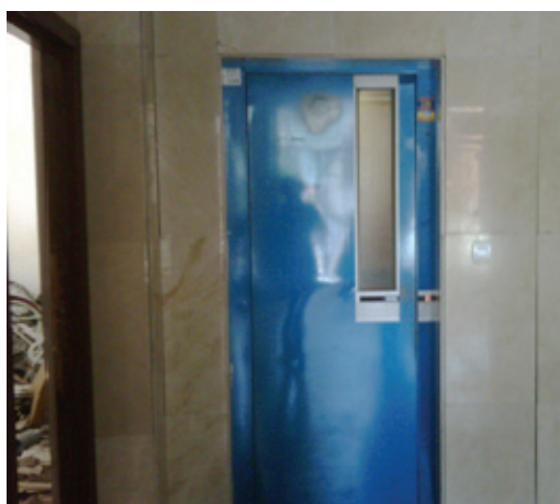
Fig. 17. Puerta de ascensor deformada por cargas de compresión
