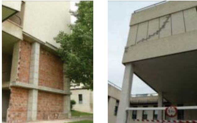
Fig. 24. a) Colapso de muros de fachada; b) fisuras en muro de fachada
