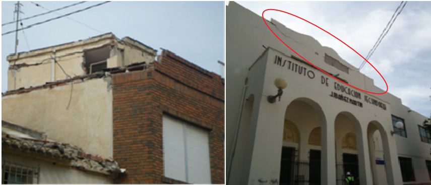
Fig. 14. Elementos no estructurales no anclados a la estructura.
