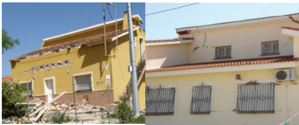
Fig. 13. Daños en viviendas unifamiliares en la pedanía de Diputación de Río en el municipio de Lorca
