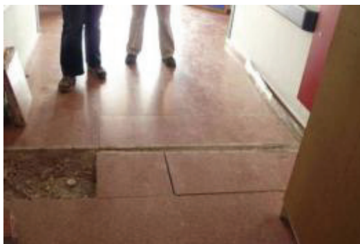
Fig. 23. Desplazamientos de la junta de dilatación
