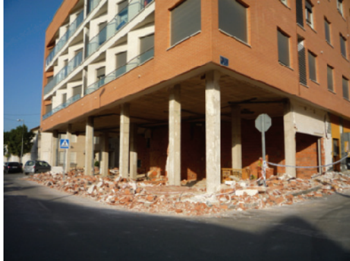
Fig. 6. Pérdida de los cerramientos por el efecto de planta blanda.
