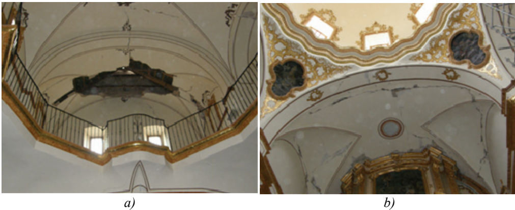
Fig. 21. Daños en el coro y arcos bajo la cúpula de la Iglesia del Carmen
