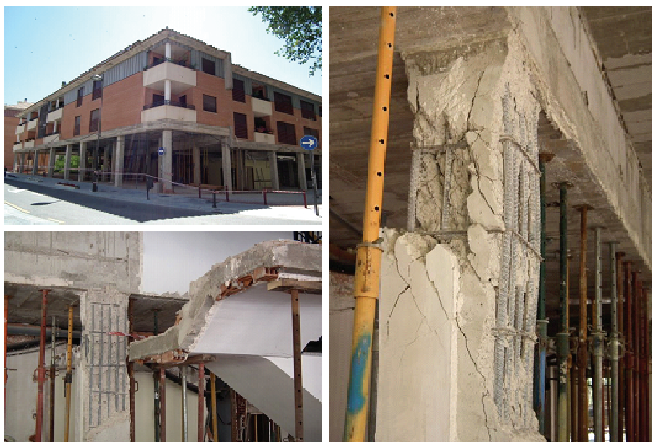
Fig. 7. Pérdida de cerramientos y daños a pilares en una planta blanda.
