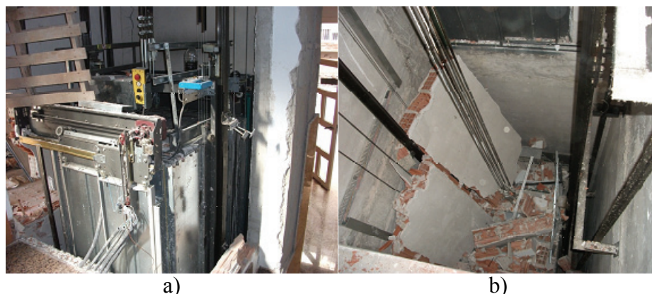
Fig. 16. a) Vista de cabina desde el exterior por cerramientos derribados b) Cerramiento de ladrillo derribado sobre el techo de la cabina del ascensor.
