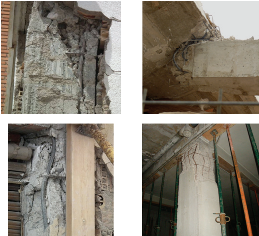
Fig. 8. Posibles deficiencias en las armaduras de refuerzo identificadas en Lorca.
