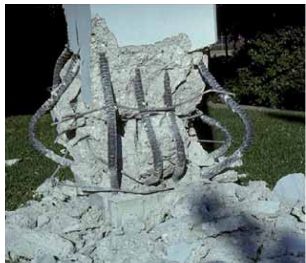
Fotografía 3.10 Pandeo de las armaduras longitudinales de un pilar, después de la rotura de los cercos por insuficiente sección.
