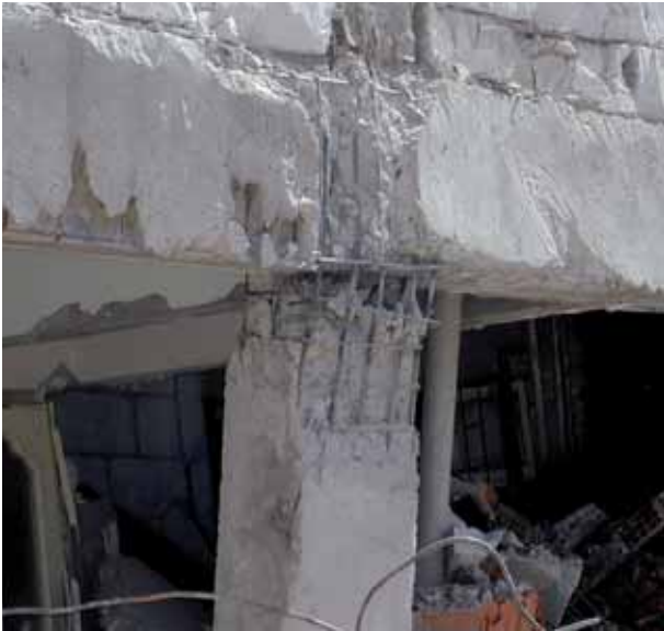
Fotografía 3.7 Fallo de un nudo y de un pilar por la falta de cercos en las proximidades del nudo.
