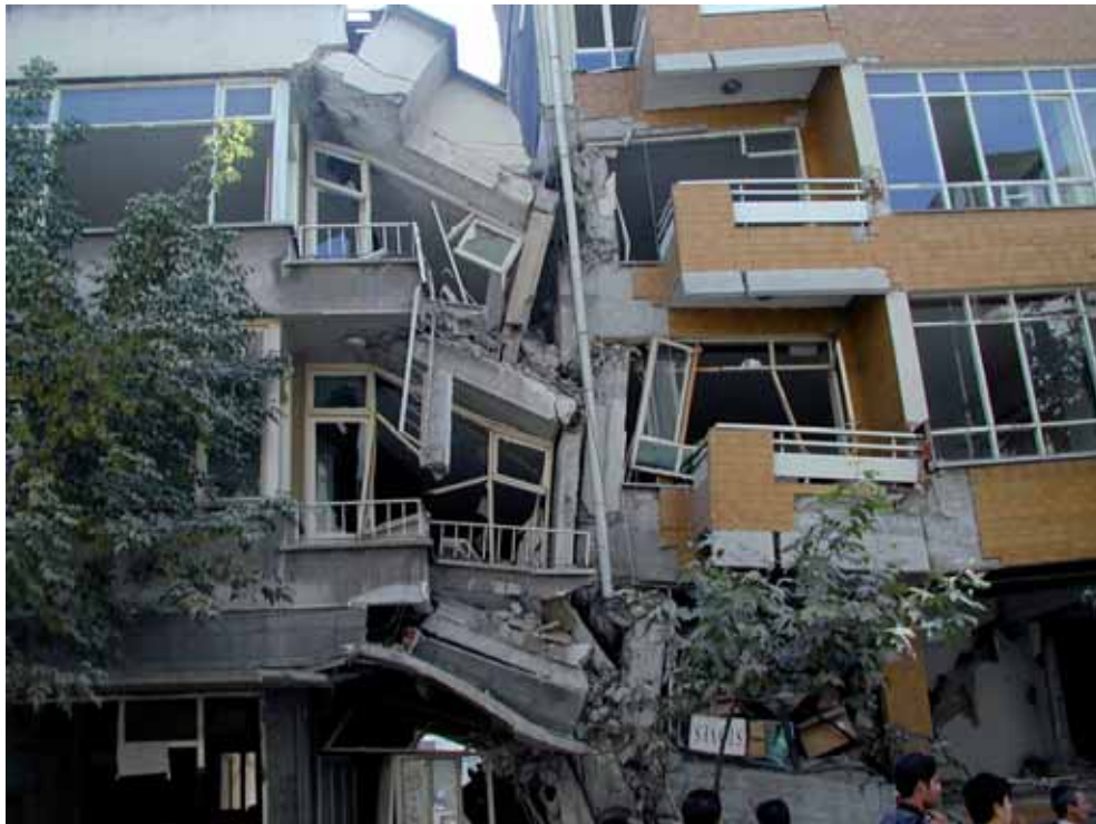
Fotografía 1.17 Pérdida parcial de sección de los pilares de hormigón armado, producto del golpeteo entre edificios, terremoto de Izmit, Turquía, 1999.
