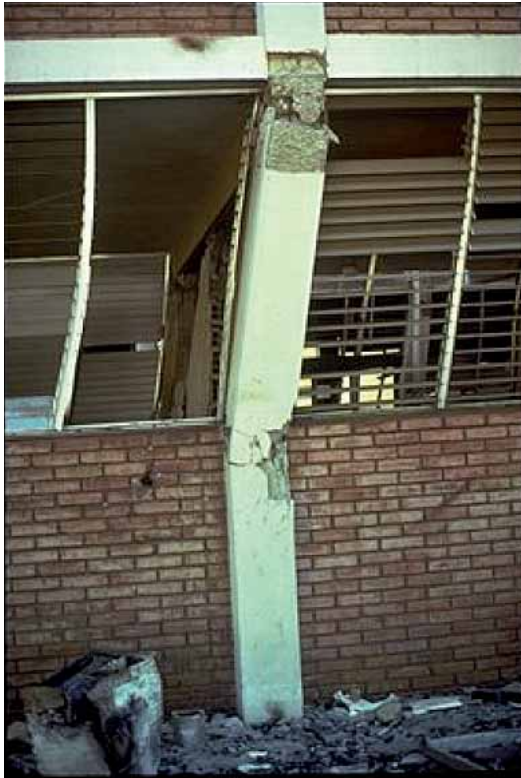
Fotografía 3.1 Efecto de pilar corto no intencionado que induce a la aparición de rótulas plásticas por fallo a cortante.
