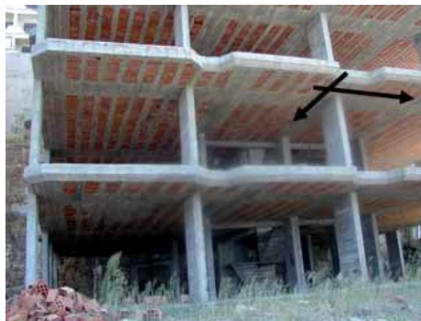
Fotografía 2.9 Deficiente distribución de rigidez en los pilares.
