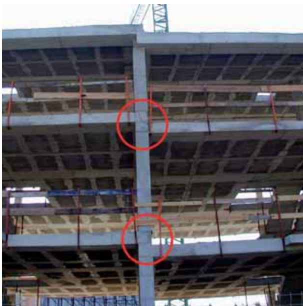
Fotografía 2.5 Juntas pilar-forjado que inducen al comportamiento de corte directo.
