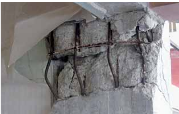
Fotografía 3.9 Pandeo del acero longitudinal como consecuencia de la plastificación de cercos excesivamente espaciados.
