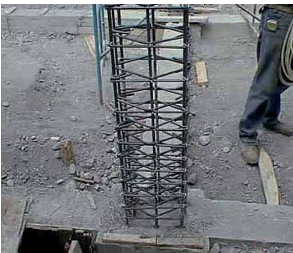
Fotografía 3.2 Detalle de armado de un pilar de un edificio emplazado en una zona de alta amenaza sísmica.
