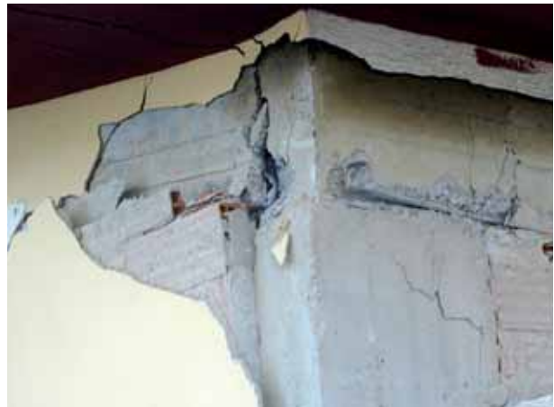
Fotografía 3.12 Defecto de anclaje del acero longitudinal de las vigas.
