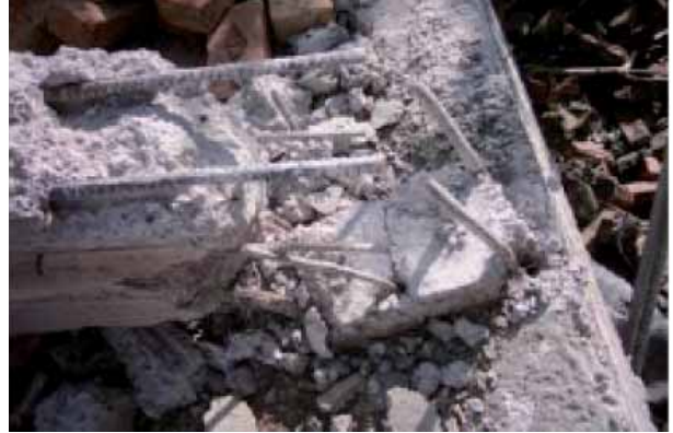
Fotografía 3.11 Fallo de un pilar por inadecuado solape de las armaduras, por carecer de cercos y por una mala calidad del hormigón.
