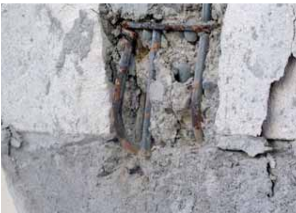
Fotografía 3.8 Cercos insuficientes en la proximidad de un nudo, el uso de armaduras lisas y armaduras ancladas en la zona de momento máximo.
