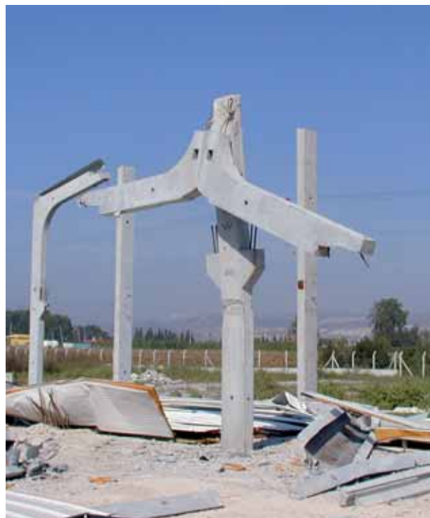
Fotografía 1.8 Fallo de las conexiones de los elementos de una estructura prefabricada durante el terremoto de Izmit, Turquía, 1999.
