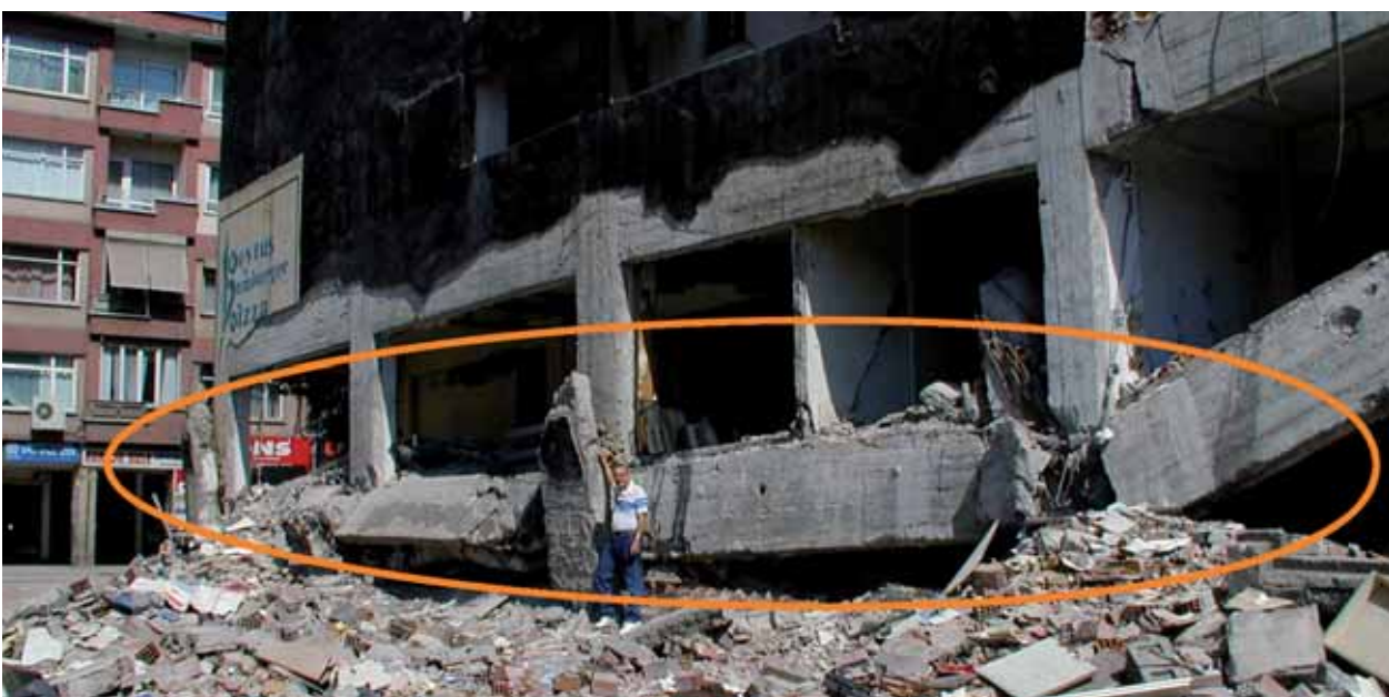
Fotografía 1.10 Colapso de planta baja débil en un edificio de hormigón armado, Adapazari, Turquía, 1999.
