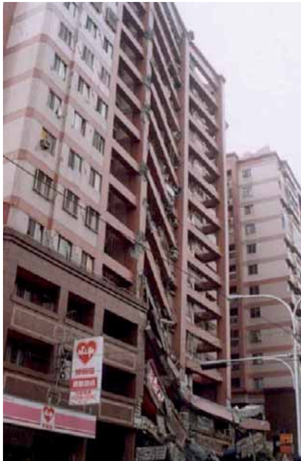
Fotografía 1.19 Colapso de las vigas de hormigón armado en un edificio durante el terremoto de Chi-Chi, Taiwan, 1999.
