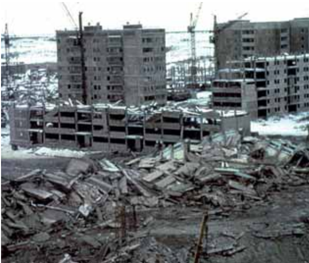
Fotografía 1.6 Edificios prefabricados dañados en diferente grado por el terremoto de Armenia de 1988.
