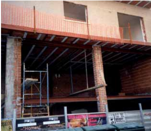
Fotografía 2.10 Apoyo inadecuado de un forjado.
