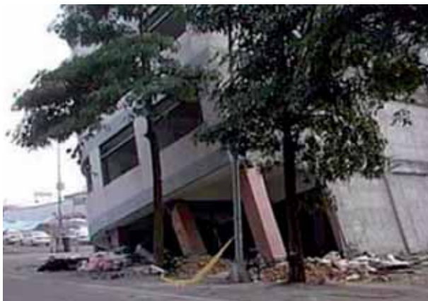
Fotografía 1.12 Combinación de efectos torsionales y de planta baja débil, terremoto de Chi-Chi, Taiwan, 1999.
