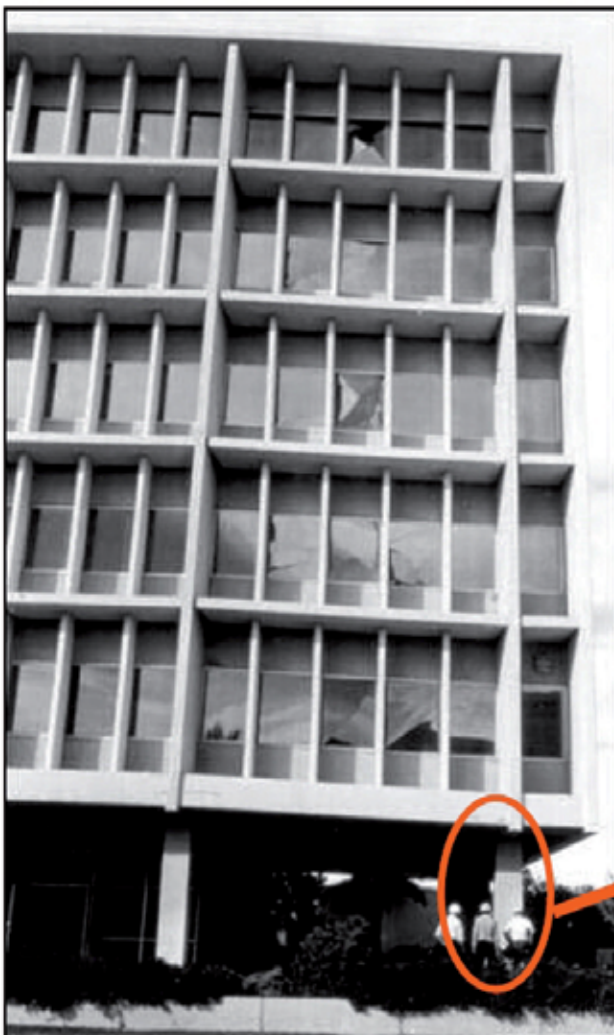
Fotografía 1.15 Formación de rótula plástica en extremo inferior de un pilar ubicado en línea exterior de un edificio con planta baja débil, terremoto de San Fernando, 1971.
