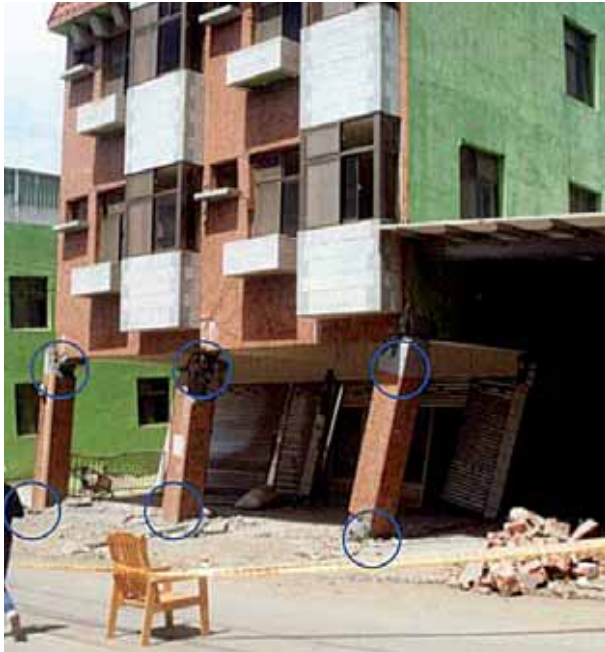
Fotografía 1.11 Comportamiento dúctil de los pilares pertenecientes a una planta baja débil en un edificio de hormigón armado, durante el terremoto de Chi-Chi, Taiwan, 1999.
