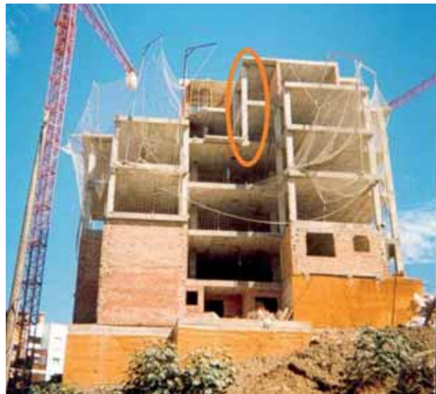
Fotografía 2.7 Discontinuidad de un pilar en las plantas inferiores de edificio.
