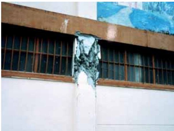
Fotografía 2.4 Efecto de fallo por cortante en un pilar corto.
