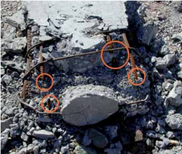
Fotografía 1.1 Fallo producido por la insuficiente ductilidad del acero longitudinal del pilar.
