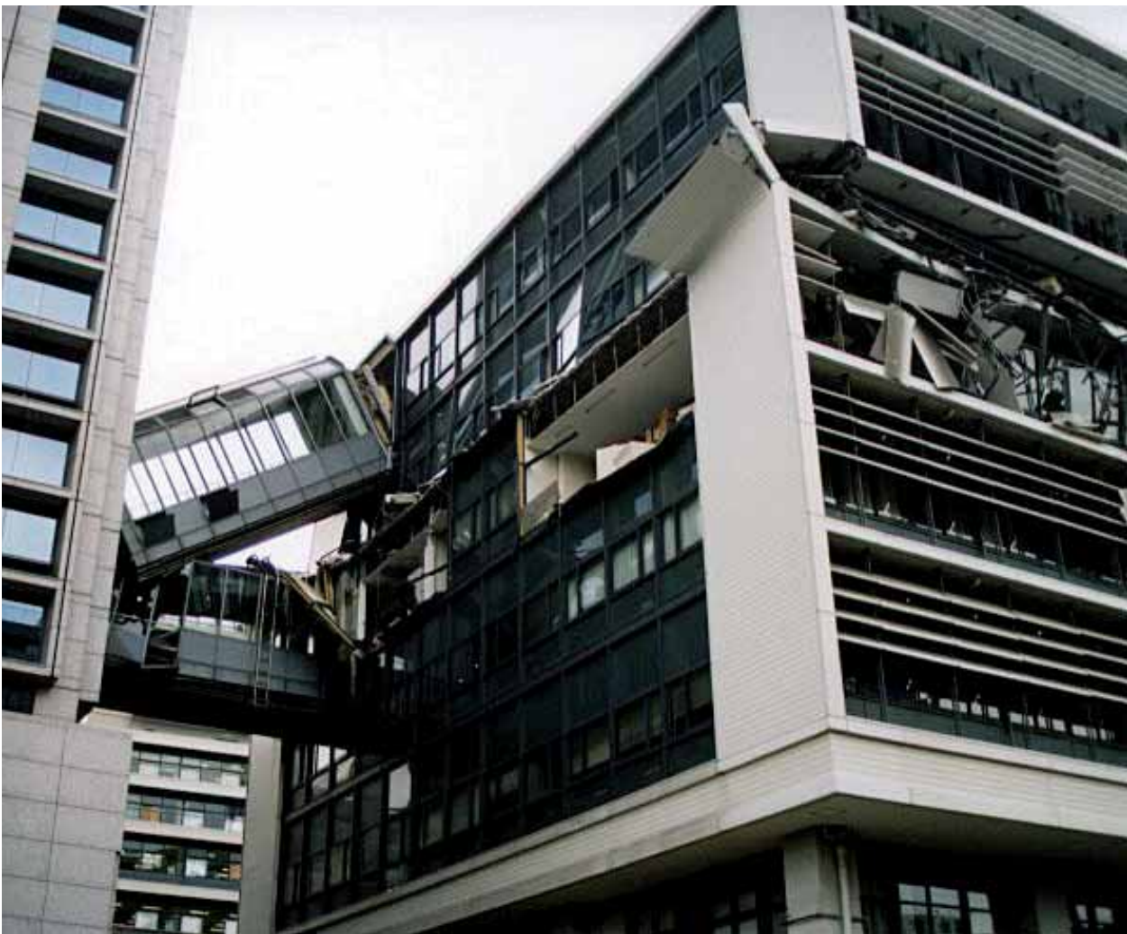
Fotografía 1.18 Interacción entre estructuras y elementos secundarios, terremoto de Kobe, Japón, 1995.
