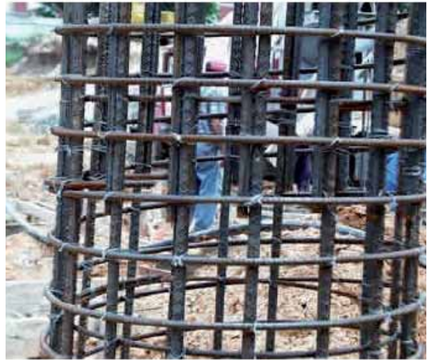
Fotografía 3.4 Detalle de armado de un pilar circular mediante cercos de una sola pieza.
