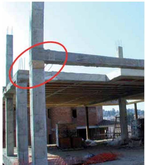
Fotografía 2.6 Falta de arriostramiento del pilar al nivel de forjado.
