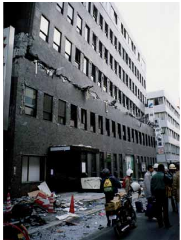
Fotografía 1.13 Desaparición de una planta intermedia como consecuencia de la formación de un mecanismo de colapso, en un edificio de 5 niveles, terremoto de Kobe, Japón, 1994.
