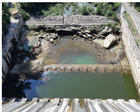
Figura 1: Estado actual del cuenco y cauce receptor.
