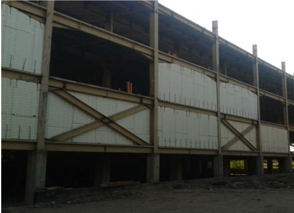
Figura 2.10. Vista externa de columnas de hormigón armado, vigas y losas de acero.
