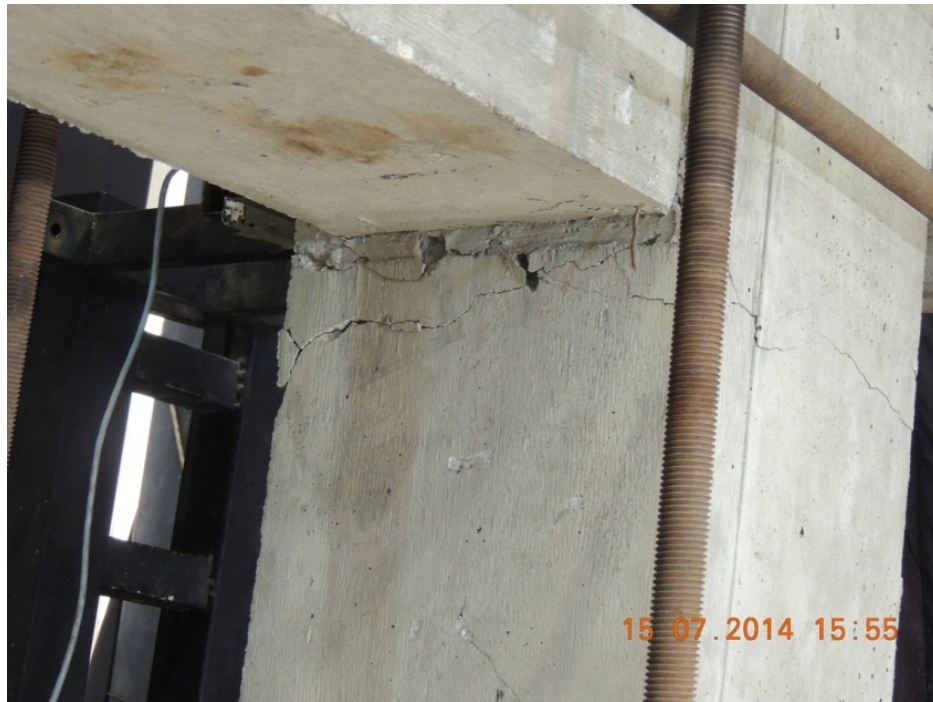
Figura 4.7. Detalle de falla general de la columna 2 de hormigón armado.
