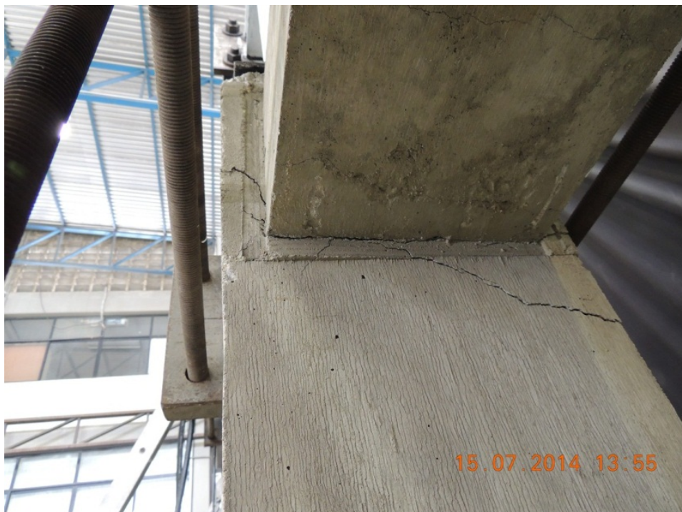
Figura 4.8. Detalle de agrietamiento general de la columna 1 de hormigón armado.
