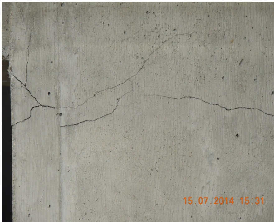
Figura 4.6. Detalle de falla por tracción y corte de la columna 2 de hormigón armado
