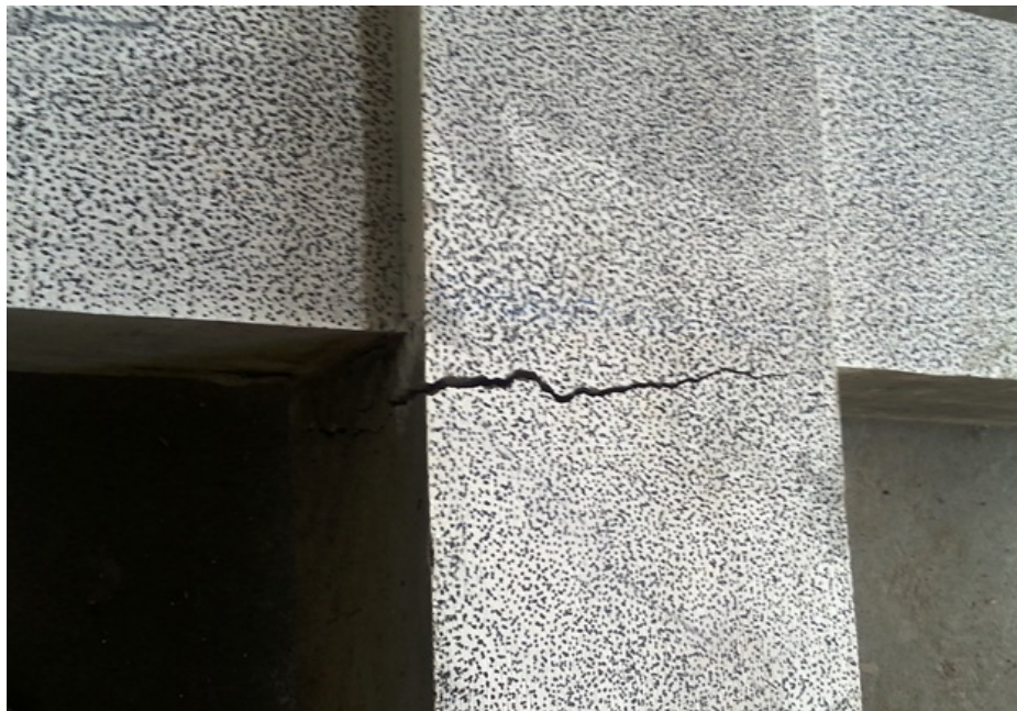
Figura 4.14. Detalle de la rotura generalizada en las caras de la columna de hormigón.
