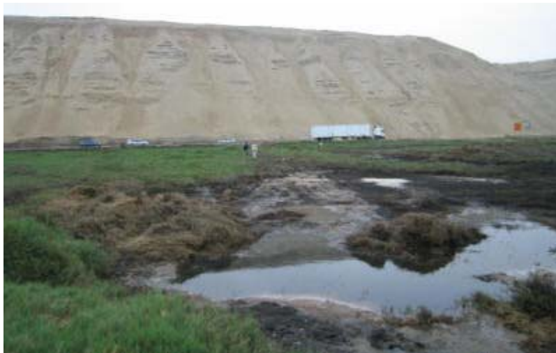
Figura 13: Vista de la carretera Panamericana en la zona de la falla del talud de 400 m de longitud. Se pueden ver depósitos de terraza marina en la parte anterior y la Formación Cañete en la parte posterior.
