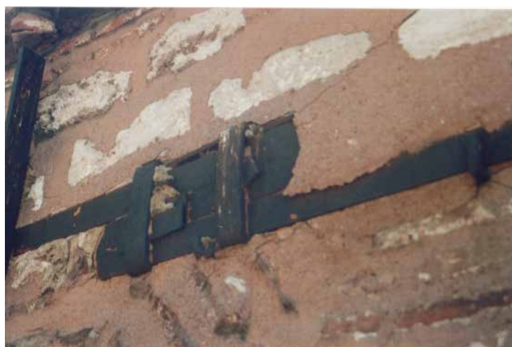
Fig.5.8 Detalle de una unión de tirante de hierro en el exterior del edificio (Pere Roca)
