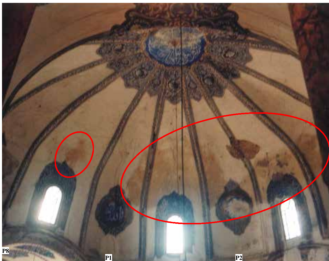
Fig.5.14 Efecto de las humedades sobre el revestimiento (Pere Roca)
