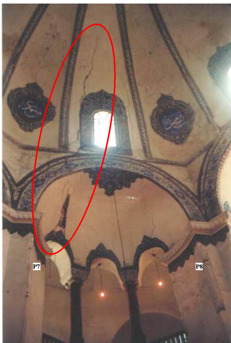
Fig.5.13 Detalle de fisuras en el lado norte de la basílica (Pere Roca)
