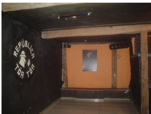
Foto 5 : Espaço do porão improvisado para o funcionamento de uma boate. Instalação elétrica externa o com emendas.
