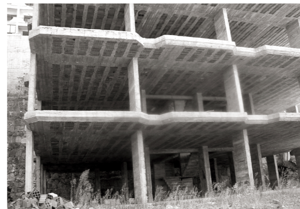
Foto 11. Deficient distribució de rigidesa en els pilars.
