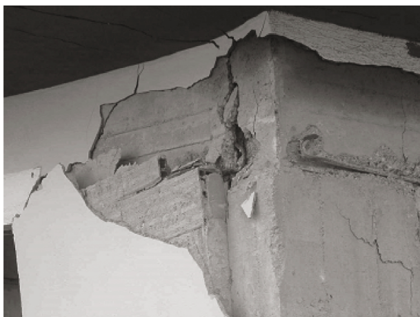
Foto 3. Armadures sense connexió en el nus, amb recobriment insuficient.
