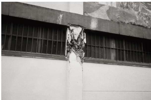
Foto 7. Fallada per tallant d'un pilar.
