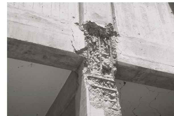
Foto 1. Esgotament d'un nus de connexió biga-pilar.
