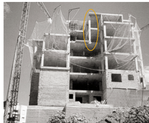
Foto 10. Discontinuitat de pilar en les plantes inferiors de l'edifici.
