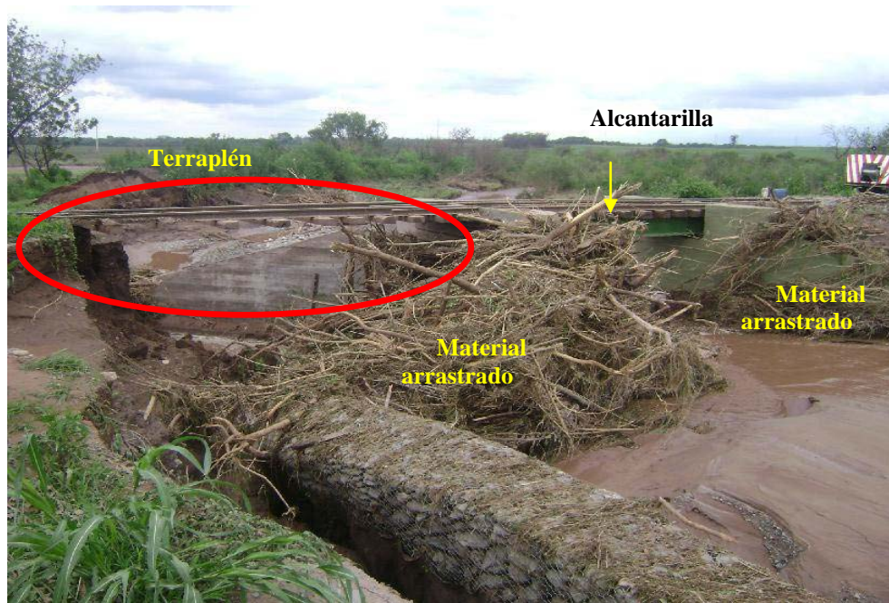
Figura 7: Margen izquierda de la alcantarilla vista desde aguas arriba luego del paso de la creciente.
