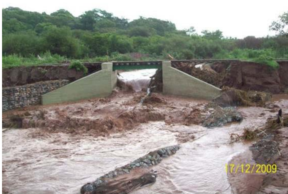
Figura 5: Vista de la alcantarilla desde aguas abajo. Fotografía tomada aproximadamente 12 horas después de la precipitación del 17 de diciembre.
