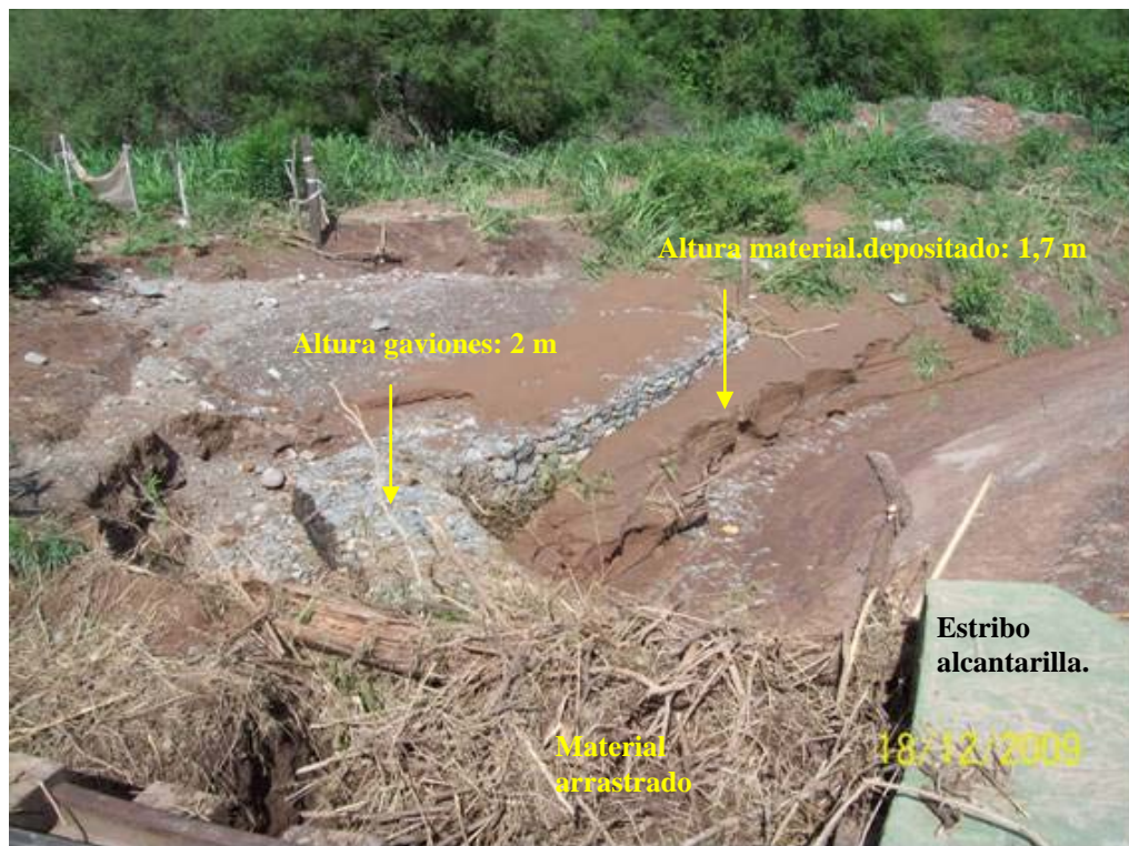
Figura 6: Defensas sobre margen derecha aguas arriba de la alcantarilla luego del evento hidrológico de referencia.
