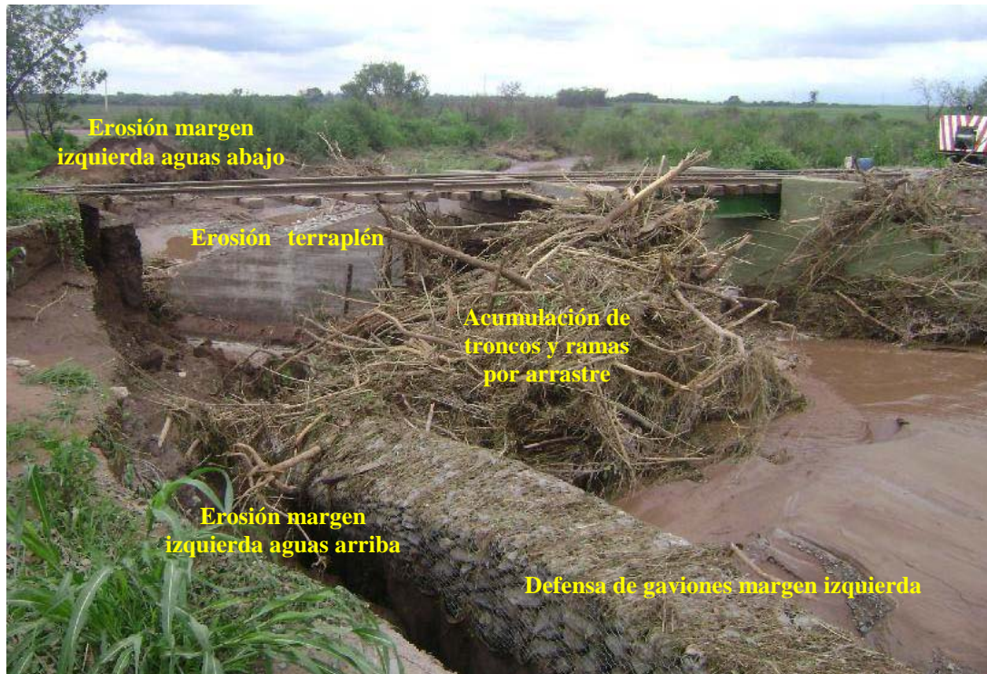
Figura 10: Análisis del colapso del terraplén lateral.
