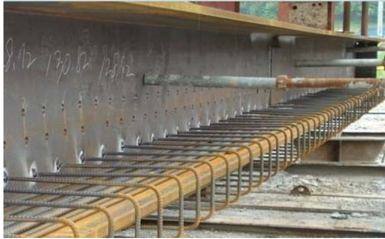
Figura 5: Refuerzo transversal para el concreto en la aleta inferior de la viga de acero.
