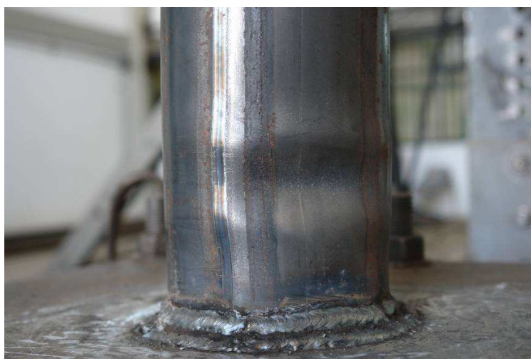
Figura 10. Aspecto del pandeo local del perfil tubular sometido a cargas biaxiales
