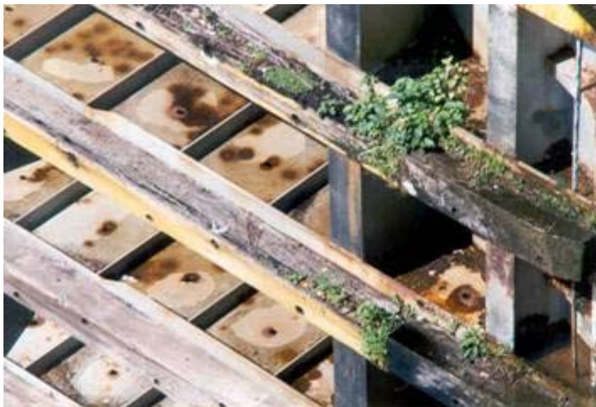
Figura 1: Corrosión en una compuerta.
