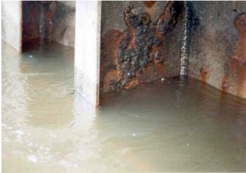
Figura 2: Corrosión en un compartimiento de una compuerta de inglete.
