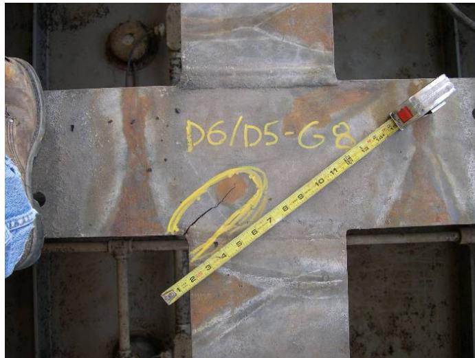
Figura 7: Ejemplo 2 de una fractura debido a fatiga.
