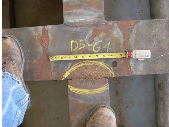
Figura 6: Ejemplo 1 de una fractura debido a fatiga.
