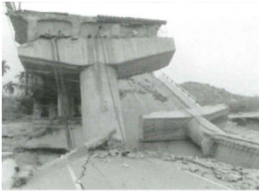
(a) Pérdida de apoyo de los vanos del puente Mingchou
