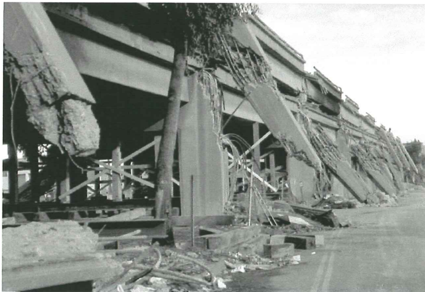
Figura 1.2 Derrumbe del tablero superior del viaducto Ciprés, en una longitud próxima a 1.5 kilómetros (Nakata et al, 1999)
