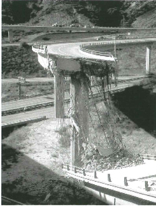
Figura 1.3 Derrumbe de los vanos 1 y 2 del conector norte de la ruta estatal I4 / I5 (EQE, 1994)
