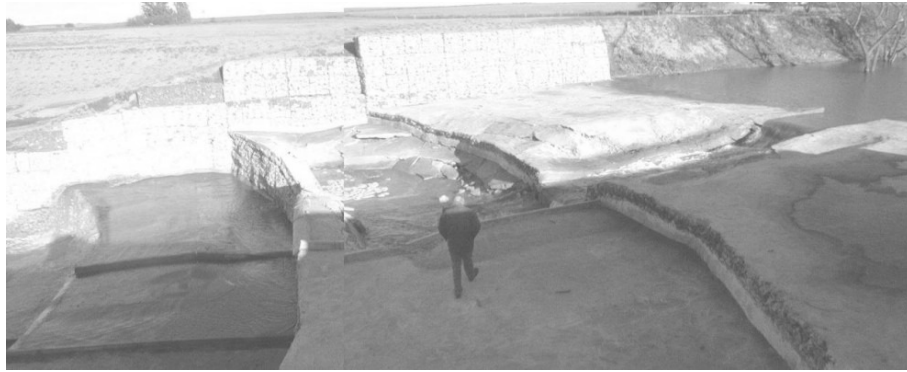
Figura 20: Zona de falla.
