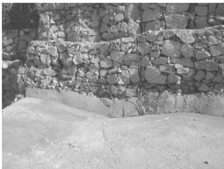
Figura 19: Deformaciones de los muros de gaviones.
