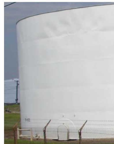
Figura 16: Nivel de daño DS2. (Fotografía del autor, octubre 11).
