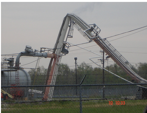
Figura 4: Colapso de una chimenea en la planta Firestone, Orange, Texas. Nivel de daño DS4. (Fotografía del autor, octubre 10).
