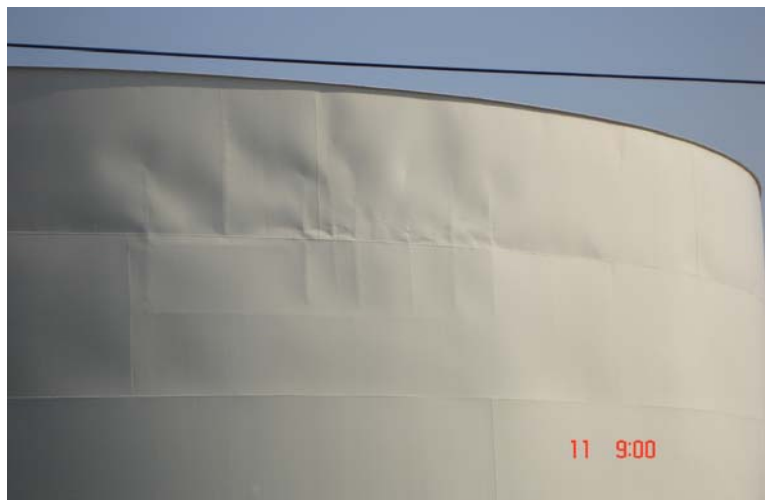
Figura 15: Port Arthur, Texas. Nivel de daño DS2. (Fotografía del autor, octubre 11).
