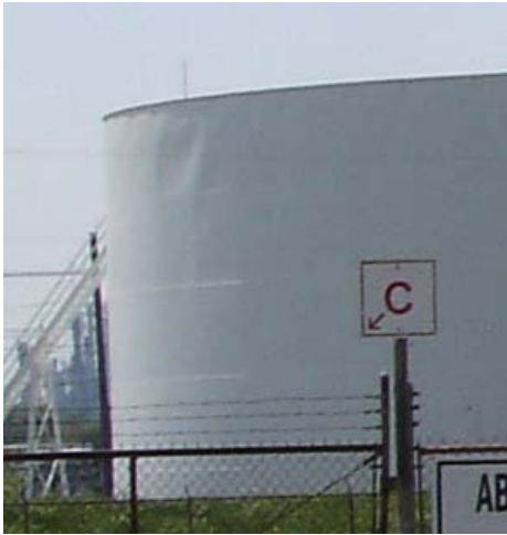
Figura 13: Port Arthur, Texas. Nivel de daño DS2. (Fotografía del autor, octubre 11).
