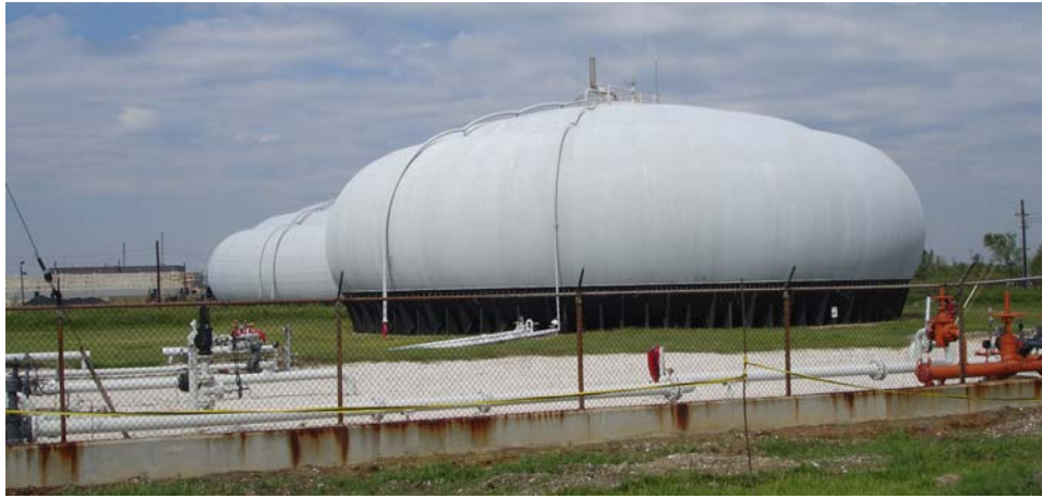
Figura 17: Port Arthur Steam Energy plant. Nivel de daño DS1. (Fotografía del autor, octubre 11).
