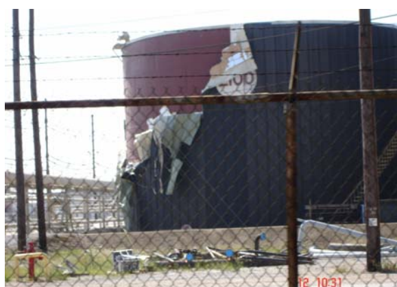
Figura 10: Planta Exxon Mobile, Beaumont, Texas. (Fotografía del autor, octubre 12).
