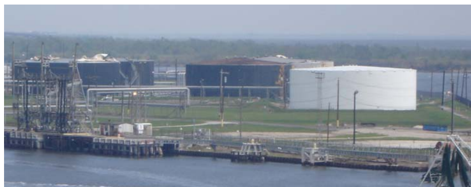
Figura 11a: Texaco Island, al sur de Port Arthur, Texas. Nivel de Daño DS3. (Fotografía del autor, octubre 11).
