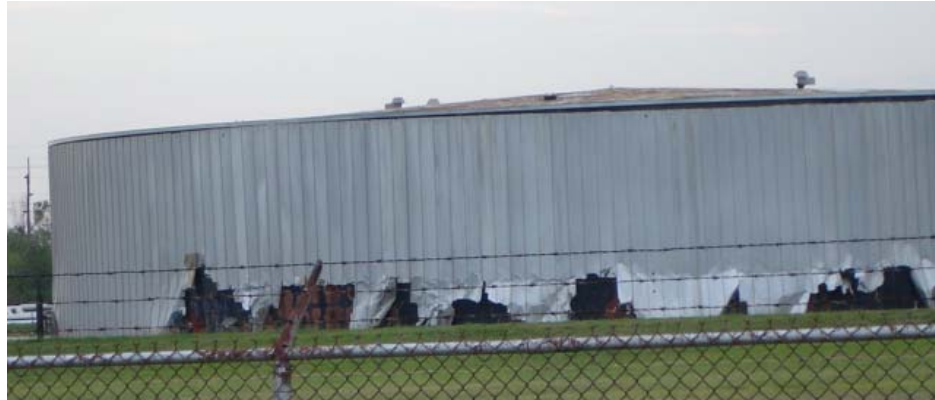
Figura 6: Daño en el aislamiento de un tanque en Port Arthur, Texas. Este tanque se encuentra en terreno plano, sin obstrucciones para el viento. (Fotografía del autor, octubre 10).
