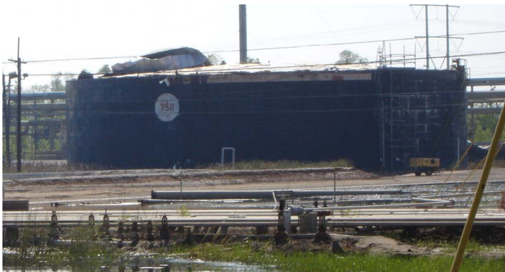
Figura 12: Exxon Mobile, Beaumont, Texas. Nivel de daño DS3 en el techo. (Fotografía del autor, octubre 12).
