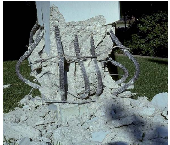
Figura 5. -Fallo de pilar (armaduras transversales lisas y en cuantía insuficiente).
