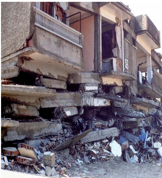
Figura 1.- Fallo frágil de un edificio.
