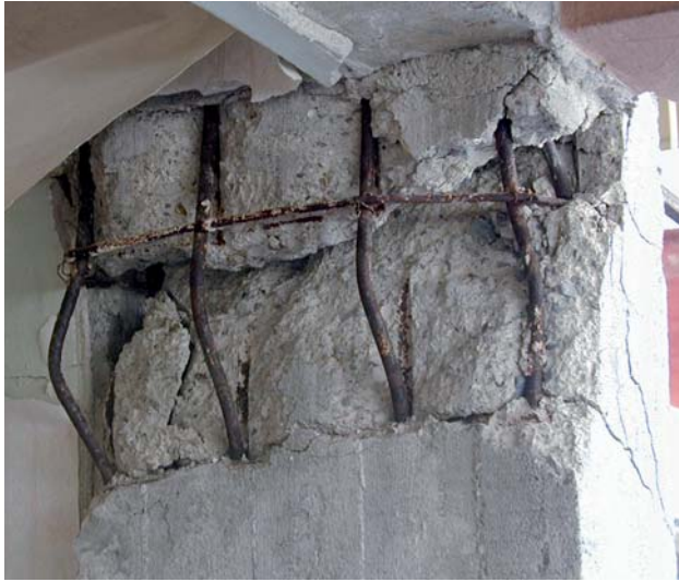
⇒ Figura 8.- Pandeo de las armaduras longitudinales por inadecuada cantidad de cercos en la proximidad de un nudo viga-pilar.
