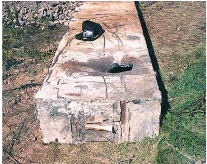
Figura 4.25: collasso dell'unione saldata tra due elementi strutturali.
