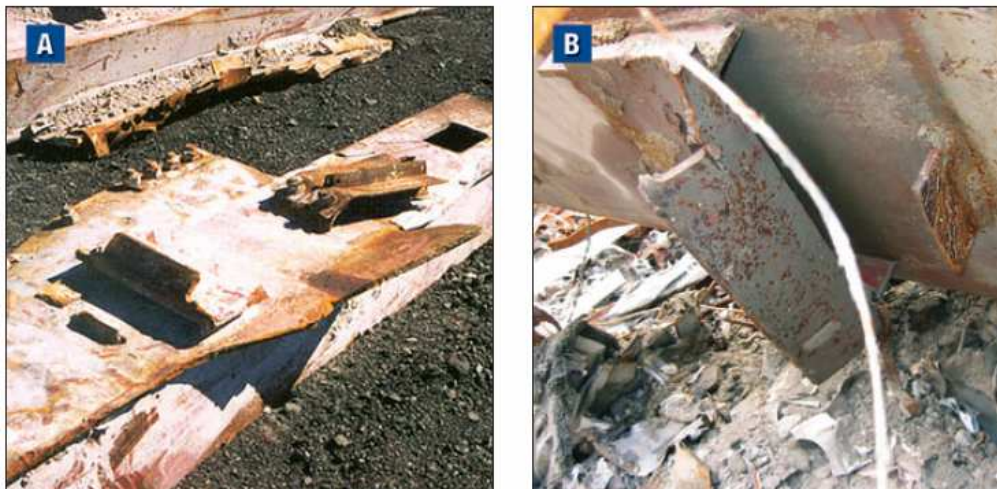
Figura 4.26: collasso delle connessioni delle travature reticolari
