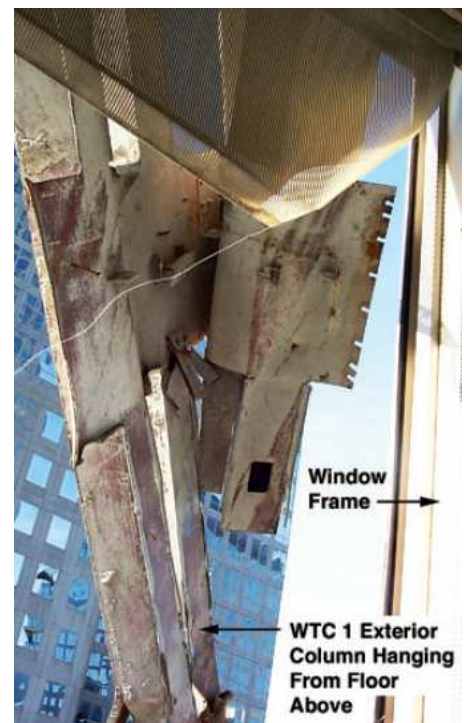
Figura 4.24: collasso della connessione in cui furono sottoposte per l'assenza dei loro vincoli laterali, uno "spandrel"
