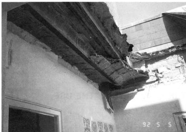
Cubierta que colapsó en el Turó de la Peira de Barcelona.
