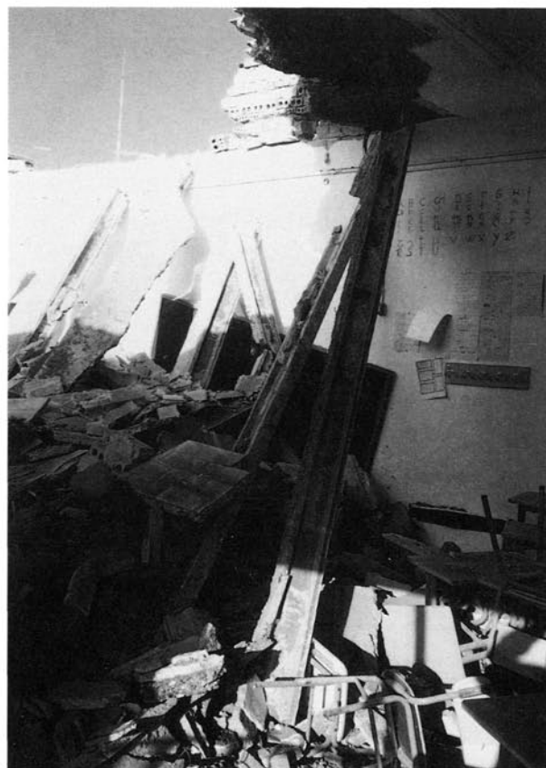
Colapso debido a aluminoso en unas escuelas de Andalucía.
