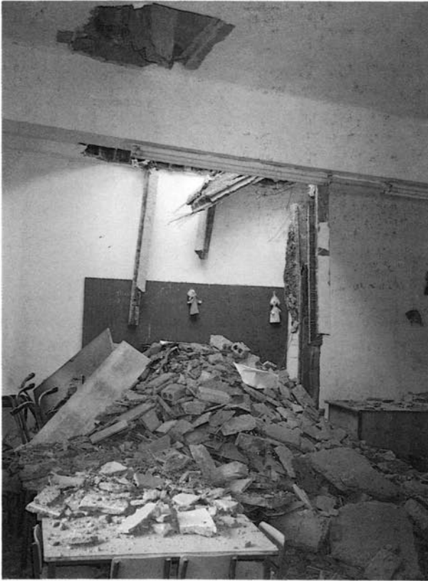
Otro aspecto del colapso de una escuela.
