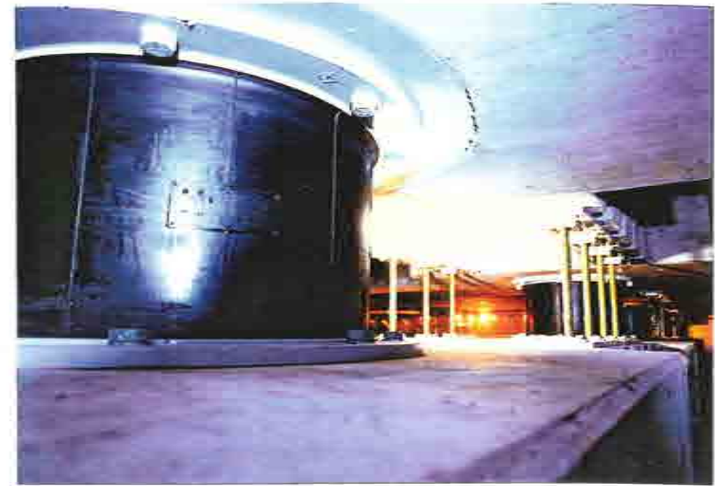
Fotografía 6.1 Centro de Investigación y Desarrollo de Obayashi Corporation. Sistema de aislamiento antisísmico: aparato de apoyo de neopreno zunchado + barras de acero como amortiguadores.
