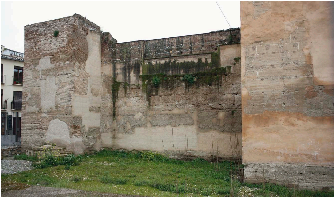
Fig. 1: Lado norte de la Puerta de Elvira con una intervención realizada en 2004-2008 que ha dejado la superficie de la tapia rugosa. A la derecha se puede ver una zona restaurada en 1992 con la superficie lisa
