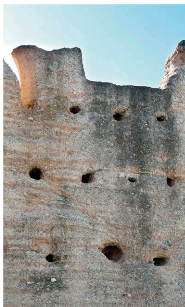
Fig. 2: Tapia calicostrada en avanzado estado de deterioro. Tramo de muralla ziri del Albaycín. Granada (Antonio Navarro Diez)
