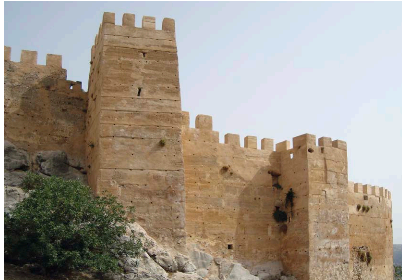
Fig. 7: Vista actual de las torres y los lienzos de muralla con presencia de nueva vegetación en algunos huecos y mechinales
