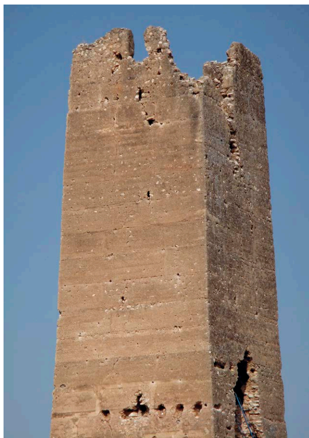
Fig. 5: Esquina noreste. Estado previo a la restauración
