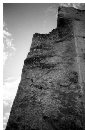
Fig. 5: Impronta de la sección inclinada del codal
