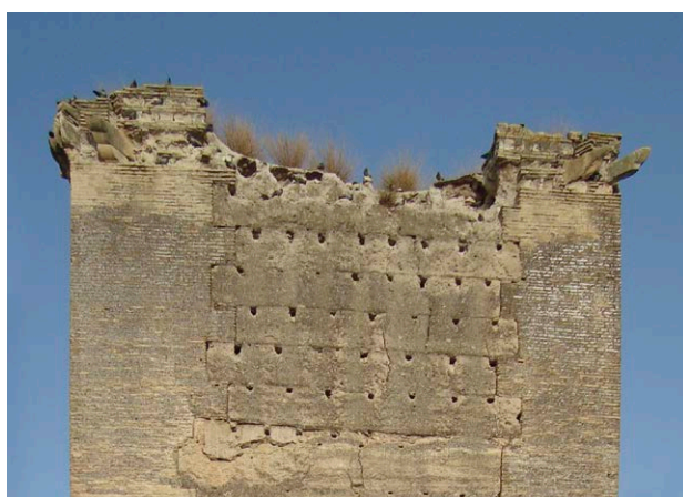
Fig. 6: Estado de conservación de un muro de tapia construido sobre un zócalo de mampostería (Alcazaba de Carmona. Foto: L. García)
