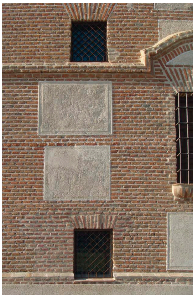
Fig. 10: Detalle de la reintegración de lagunas texturadas de los cajones de tapia en la Ermita de Nuestra Señora del Pinarejo en Aldeanueva del Codonal (Segovia)
