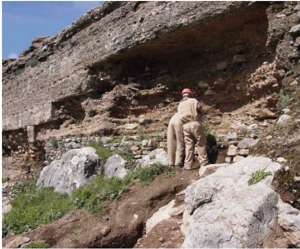
Fig. 1: Lienzo de muralla, donde se puede ver la tapia erigida sobre zócalo de piedra y también directamente sobre la roca natural
