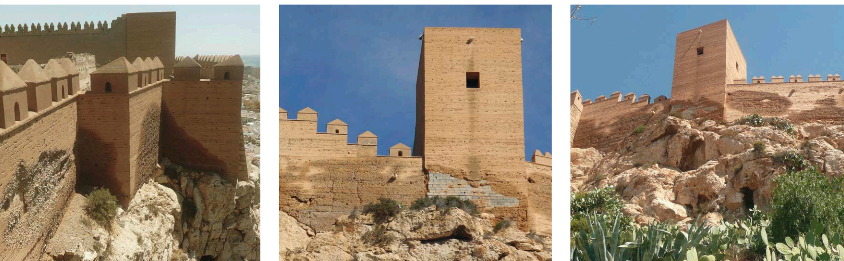
Fig. 3 a-b-c: Estado actual de la muralla meridional de la alcazaba de Almería, tras las restauraciones de los años ochenta del siglo XX. Nótese la existencia de pérdidas del material de la restauración debido a la existencia de humedades
