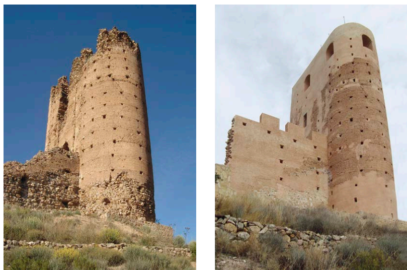
Fig. 4: Iz.: Vista antes de la intervención, se aprecia las zonas inferiores de la torre que han perdido la capa superficial (web del Ministerio de Fomento). Der.: Vista actual tras la intervención (imagen de la autora)
