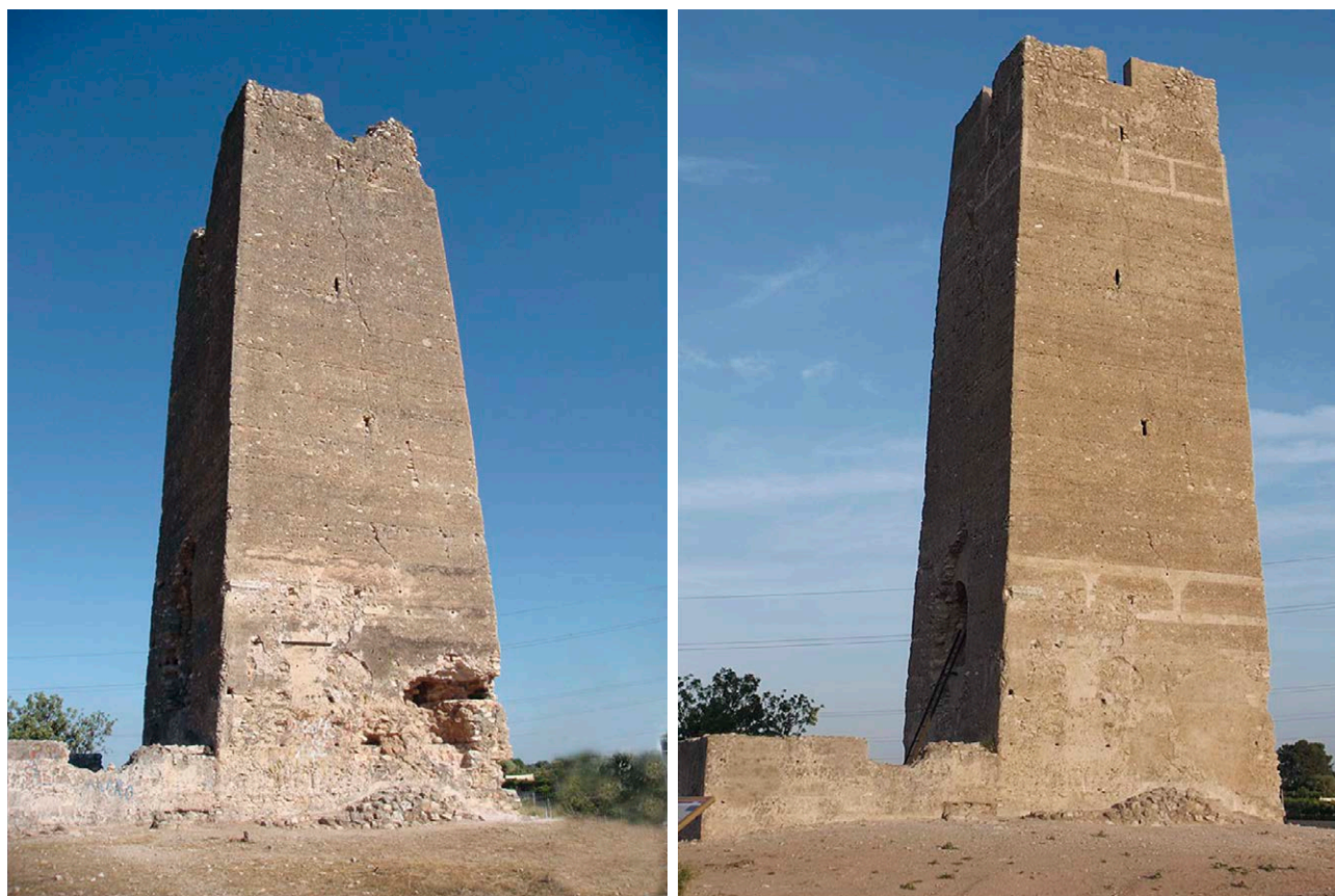
Fig. 7: Esquina noroeste. Estado anterior y posterior a la restauración
