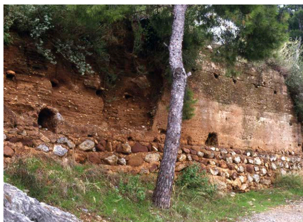
Fig. 2: Estado del muro del tercer recinto visto desde el exterior del castillo
