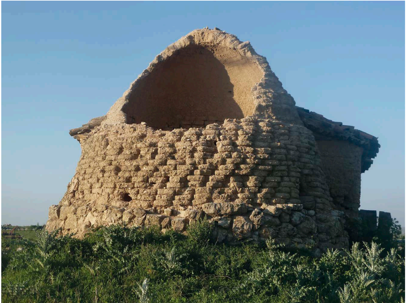
Fig. 3: Guardaviñas del municipio de Uruña (Valladolid) en estado arruinado por falta de mantenimiento
