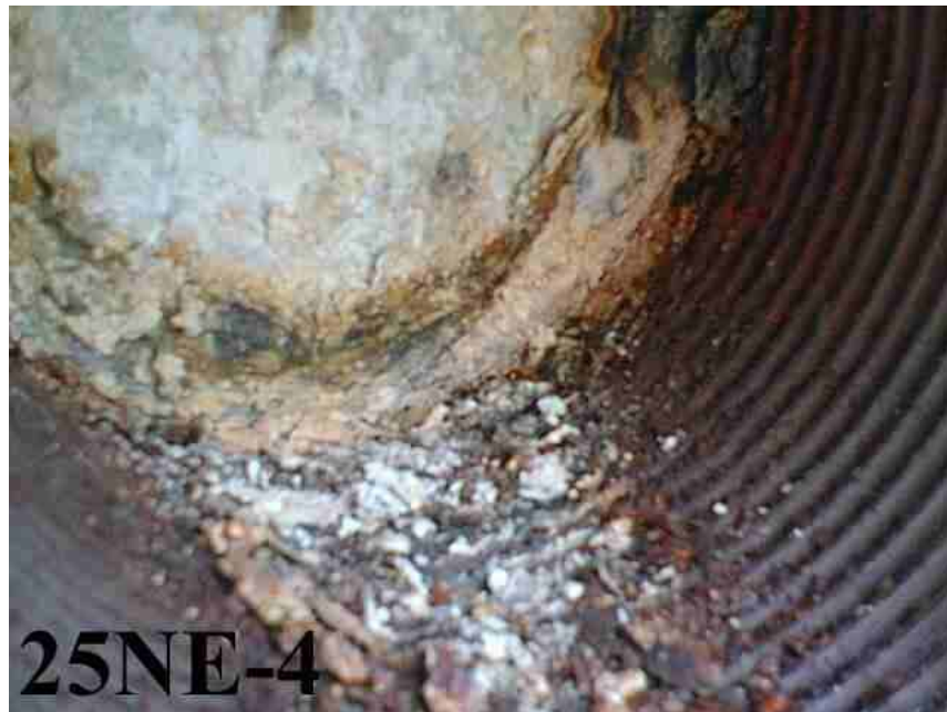
Figura 5: Daños por corrosión en anclajes inferiores de los cables
