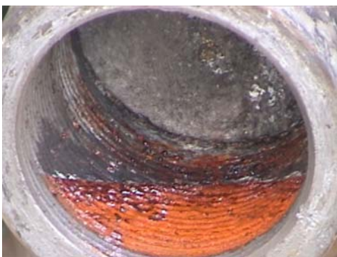
Figura 17: Cabezal de cable oxidado y desplazado
