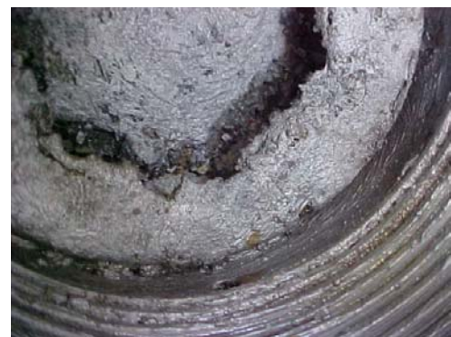
Figura 18: Cabezal de cable desplazado y agrietado en el centro
