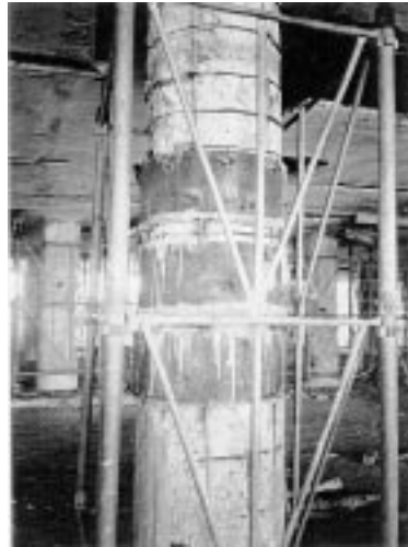
Figura 5: Cintamento metálico emergencial para estabilização dos pilares rompidos.
