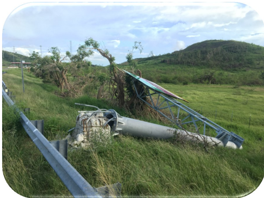
Figura 9: Falla por torsión en la base de carteles tipo cercha sobre postes en voladizo.
