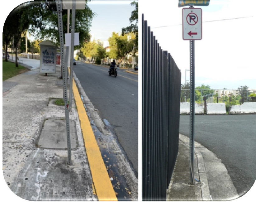
Figura 8: Falla por flexión y pandeo lateral flexo-torsional en carteles apoyados en postes de tubulares cuadrados y de sección canal.
