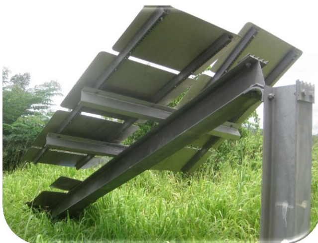
Figura 7: Falla por fractura en pacas de carteles sobre postes de acero de sección W.
