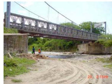
Foto 8: Provisional Tipo Bailey. Puente Argelino Duran Quintero (Regional Huila).
