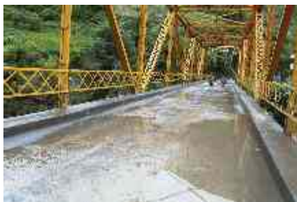
Foto 19: Deterioro de la carpeta por Empozamiento de agua e insuficiencia de drenes. Puente López (Norte de Santander).
