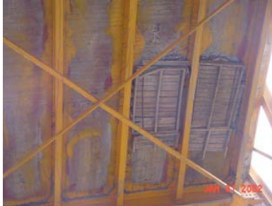
Foto 42: Deficiencias en la construcción. Puente Paso Real (Antioquia).
