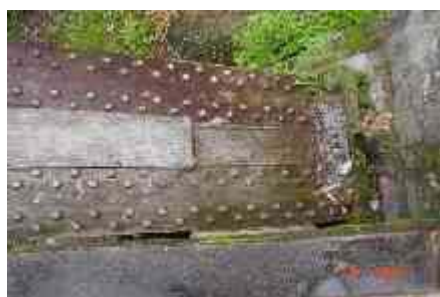
Foto 47: Corrosión y refuerzo inadecuado. Puente Quebrada Blanca (Meta).
