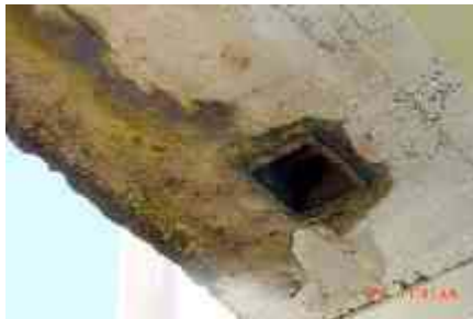
Foto 36: Problemas de infiltración y descomposición del concreto, por drenes cortos. Puente Río Cabi (Choco).
