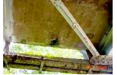
Foto 43: Fisuras reticulares y eflorescencias, corrosión del acero. Drenes tapados por sobrecarpeta. Puente Quebrada Anchique (Huila).
