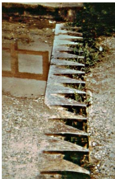
Foto 21: Problemas de asentamiento en terraplén de acceso y descomposición de junta dentada. Puente San Pablo (Chocó).
