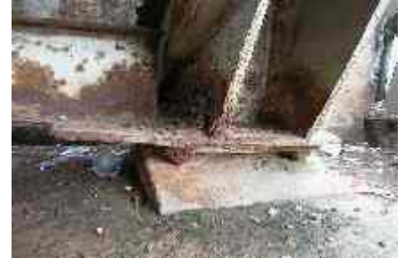
Foto 34: Corrosión en el apoyo. Puente la Unión (Norte de Santander).
