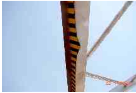
Foto 56: Pandeo Local en cordón superior. Puente Saldaña (Tolima).
