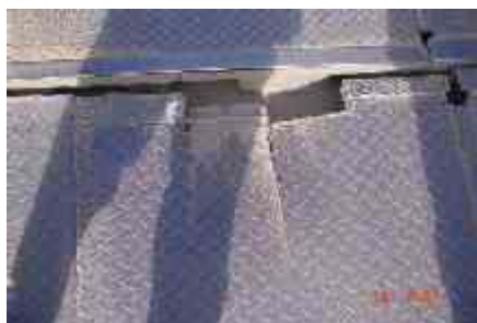
Foto 22: Falla estructural de junta. Puente Río Upía (Meta).
