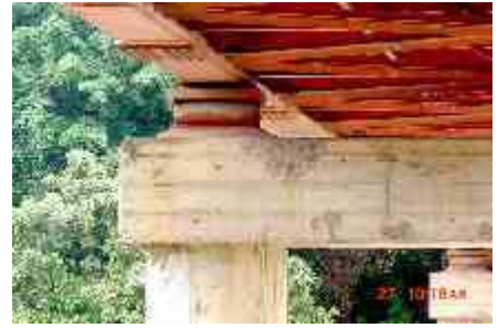
Foto 31: Apoyo tipo rodillo inadecuado desde el punto de vista sísmico. Puente Francisco de Paula Santander (Huila).
