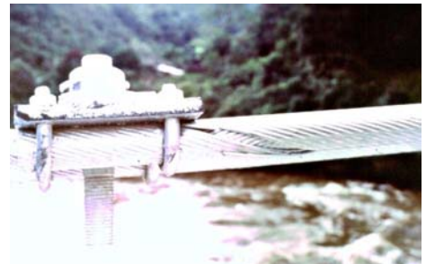
Foto 51: Catenaria principal con falla en los alambres. Puente Domenico Parma (Caldas).
