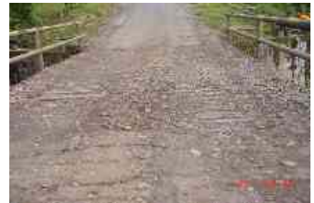
Foto 17: Base estabilizada en mal estado. Puente El Sábalo (Putumayo).
