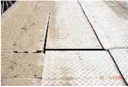
Foto 38: Falla de laminas por inadecuada soldadura. Puente Tobasía (Boyaca).
