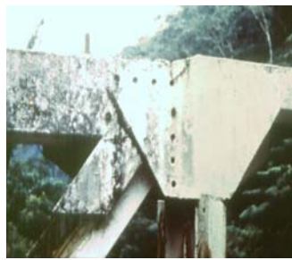
Foto 53: Falta de pernos, problemas de vibraciones y fatiga.
