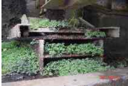
Foto 33: Humedad y falta de mantenimiento Puente el Limón (Meta).
