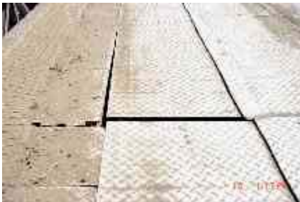
Foto 35: Falla de laminas por inadecuada soldadura. Puente Tobasía (Boyaca).
