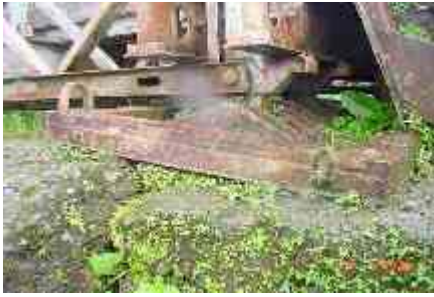
Foto 29: Corrosión y falta de alineamiento en el apoyo. Puente Tutunendo (Chocó).
