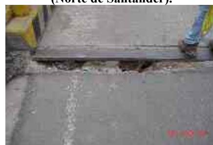
Foto 25: Problemas de impacto e infiltración en las juntas. Puente Río Caquetá (Putumayo).
