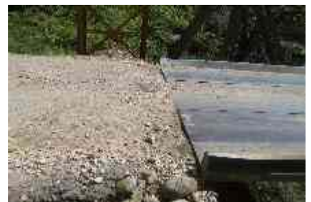
Foto 20: Sin superficie de rodadura en terraplén. Puente Cubugón (Norte de Santander).
