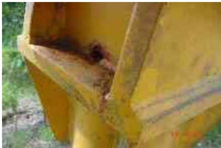
Foto 49: Corrosión. Puente La Balsa (Meta).
