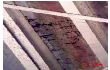
Foto 37: Acero expuesto y falta de recubrimiento. Puente Luis Ignacio Andrade (Tolima).
