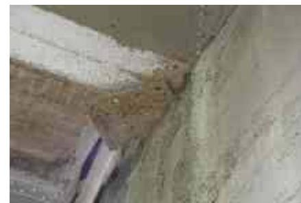
Foto 28 Falla del apoyo. Puente Río Timbío (Cauca).
