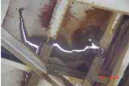
Foto 41: Problemas de corrosión y falla estructural. Puente el Limón (Meta).
