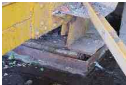
Foto 27 Corrosión y deterioro del apoyo. Puente Dos Ríos (Cauca).
