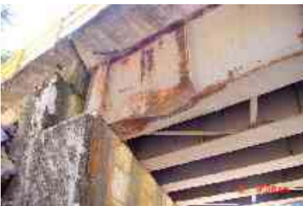
Foto 45: Corrosión e impacto, generó disminución de sección de viga. Puente Muros (Boyacá).
