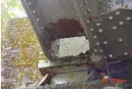
Foto 32: Corrosión generalizada en el apoyo. Puente Fragua Chorroso (Caquetá).
