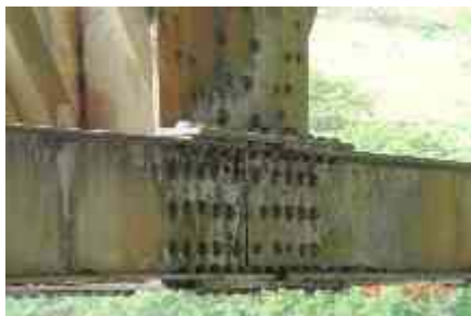
Foto 52: Corrosión generalizada en unión mediante remaches. Puente El pescado.
