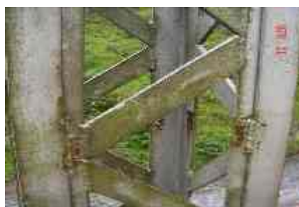
Foto 48: Deficiencias en soldadura. Puente Quebrada Blanca (Meta).
