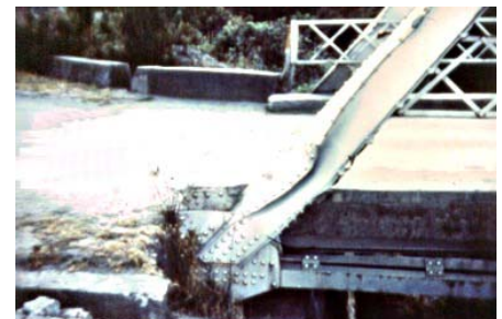
Foto 54: Impacto en el cordón superior que afecta estabilidad general del puente.
