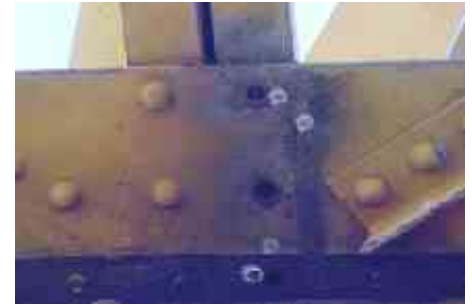
Foto 57: Corrosión y falta de pernos en el cordón inferior. Puente Dos Ríos (Cauca).
