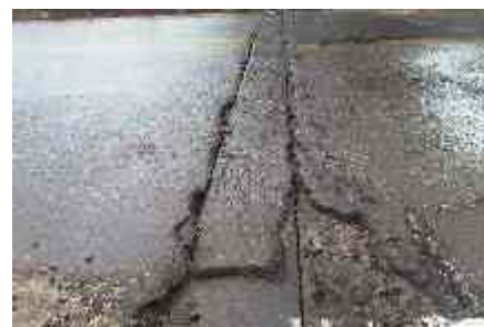
Foto 23: Descomposición del concreto cerca de la junta. Puente el Mestizo (Norte de Santander).
