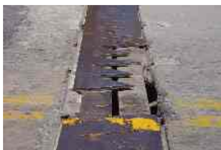
Foto 24: Falla de junta dentada. Puente Dos Ríos (Cauca).
