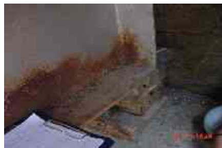
Foto 26. Corrosión y movimiento horizontal en el apoyo. Puente Icel Mocoa (Putumayo).
