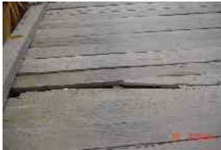
Foto 16: Superficie en madera deteriorada. Puente Río Balsillas (Huila).
