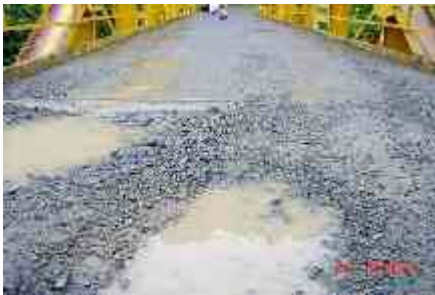
Foto 15: Empozamiento de agua y deterioro del terraplén. Puente la Playa (Chocó).
