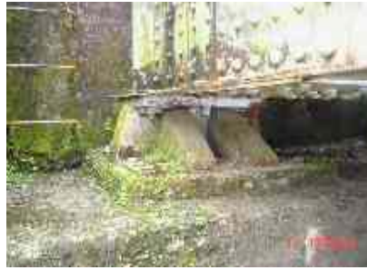
Foto 30: Corrosión producida por infiltración y desagüe de la armadura. Puente Certegui (Choco).
