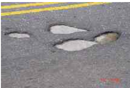
Foto 18: Baches y empozamiento de agua. Puente Chirajara (Meta).
