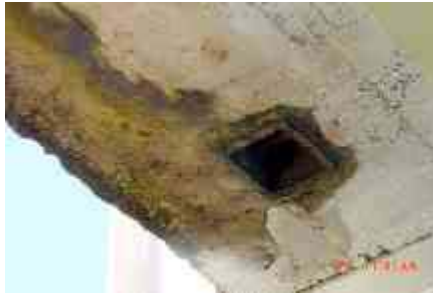
Foto 39: Problemas de infiltración y descomposición del concreto, por drenes cortos. Puente Río Cabi (Choco).
