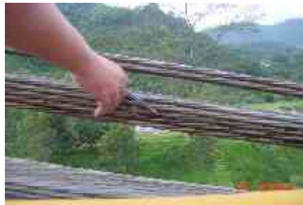
Foto 50: Corrosión interna en cables principales de catenaria. Puente Domenico Parma (Caldas).
