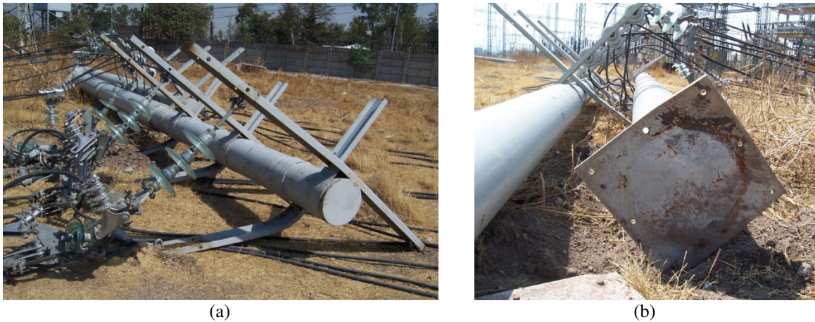
Figura 1: Ejemplo de colapsos de postes de acero por viento intenso: a) Colapso de postes en subestación Santa Cruz; b) Colapso de ocurrido en enero 2009.
