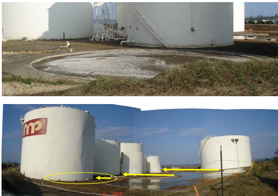
Figura 15: Fallas del patio de tanques - Terminal MP Munro.
