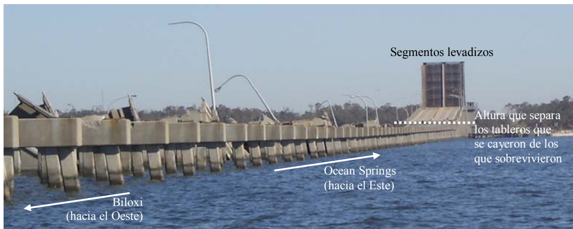
Figura 10: Puente de la Carretera Nacional 90. Los tableros de 120 segmentos (de un total de 148 segmentos) fueron desplazados de su posición por la tormenta.
