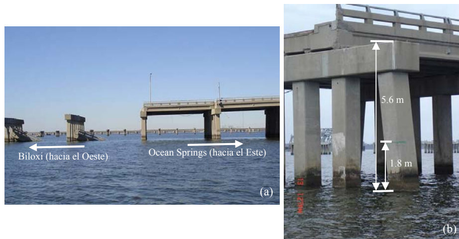
Figura 12: Falla en el puente sobre la carretera Nacional 90 en la Bahía de Biloxi. (a) Todos los tableros hacia Biloxi se cayeron durante el huracán. (b) La altura que separa los tableros desplazados de los que mantuvieron su posición es de 5,6 m. El mismo fenómeno se registró hacia el este del canal de navegación.
