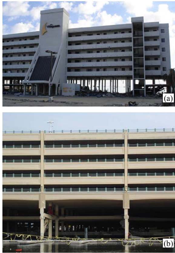
Figura 13: Pérdida de piso en estructuras de hormigón prefabricadas por efecto combinado de flotación-y-empuje. (a) Condominio Windjammer y (b) Edificio de estacionamiento del Casino Beau Rivage.
