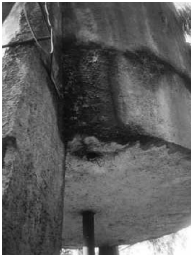
Figura 6: Aspecto da deterioração da laje de fundo e paredes do reservatório
