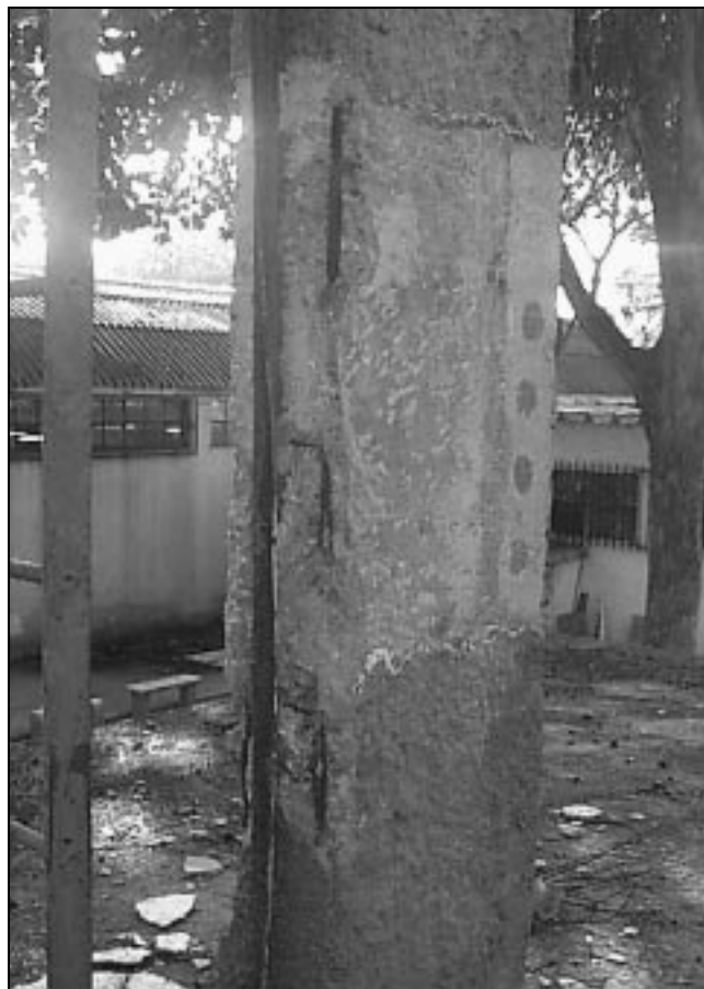
Figura 4: Aspecto da deterioração dos pilares
