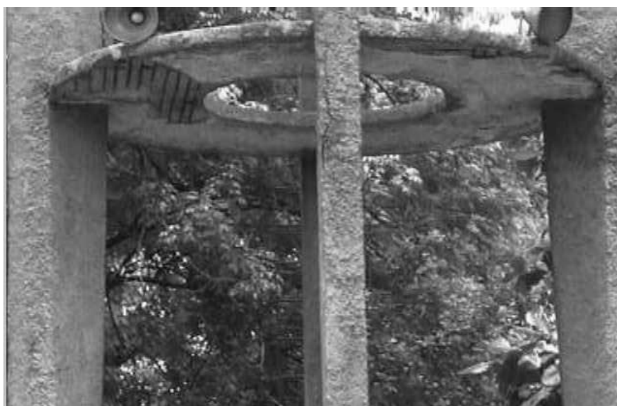
Figura 5: Aspecto da deterioração da laje do anel intermediário
