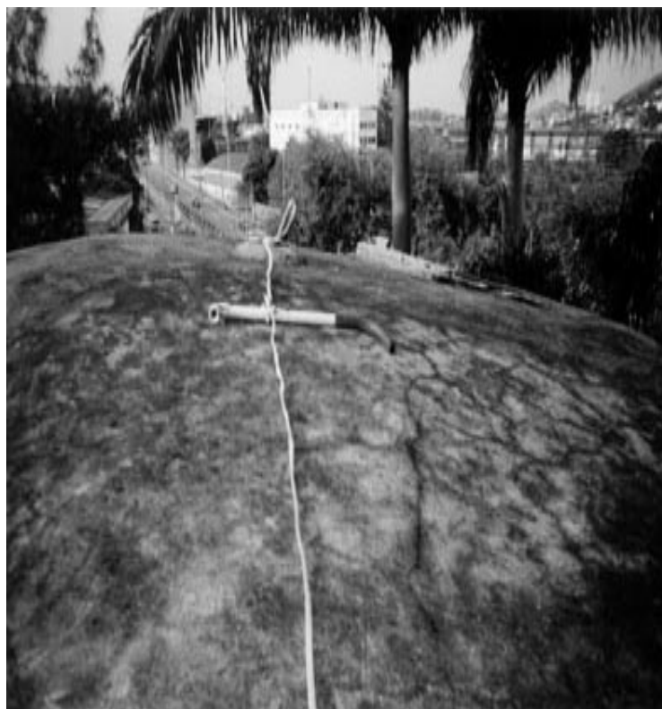
Figura 7: Aspecto da deterioração da laje superior do reservatório
