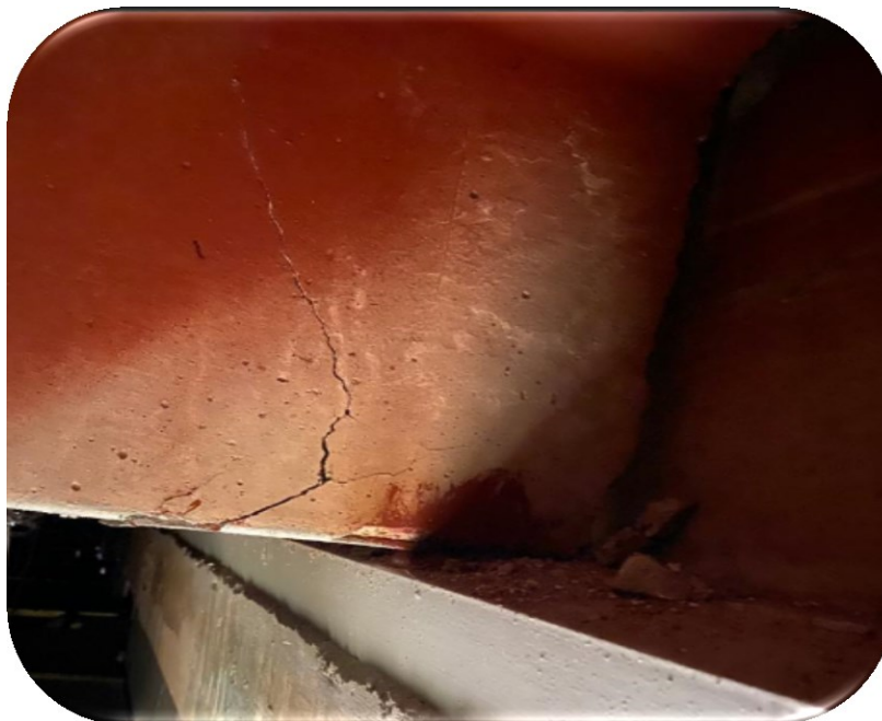
Figura 4: Grietas en unión de viga doble T y viga prefabricada.
