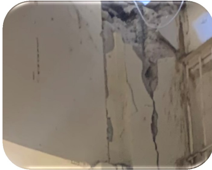
Figura 5: Falla en unión de viga y proyección de columna hecha con posterioridad.
