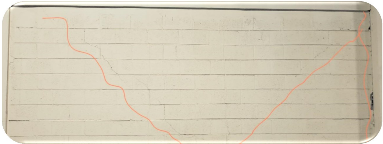
Figura 7: Grietas diagonales en paredes de bloque.
