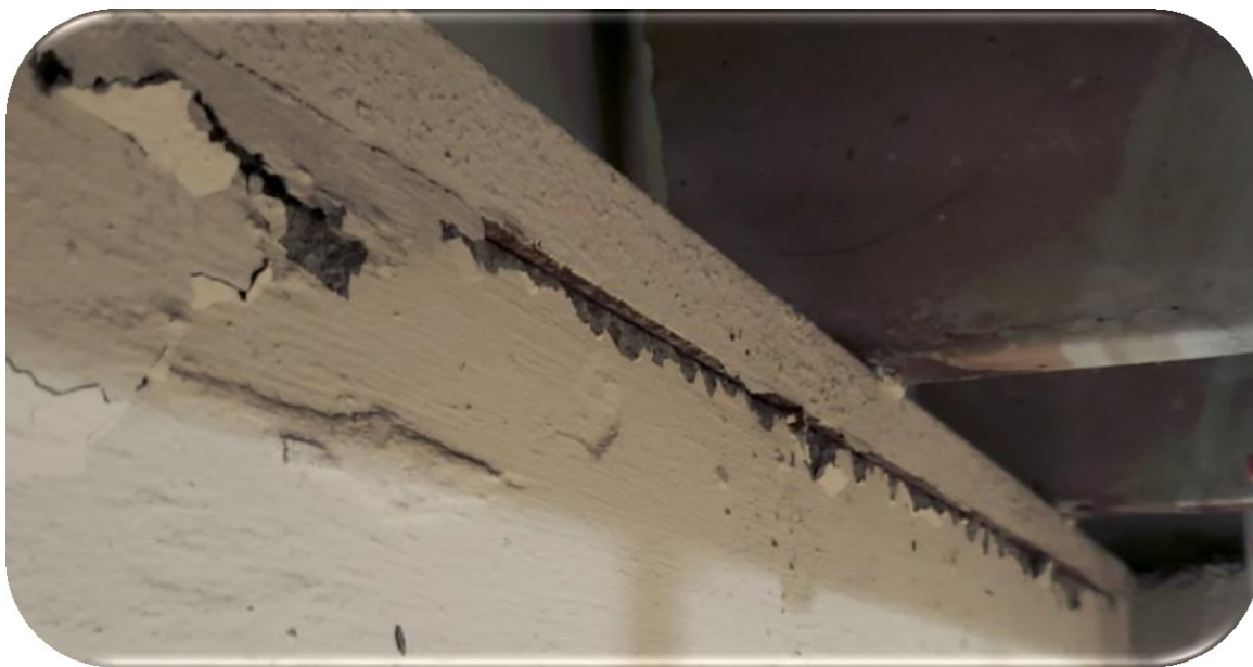
Figura 3: Desprendimiento de angular y hormigón.
