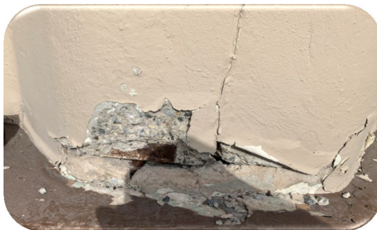
Figura 6: Desprendimiento de hormigón en base de pared prefabricada.
