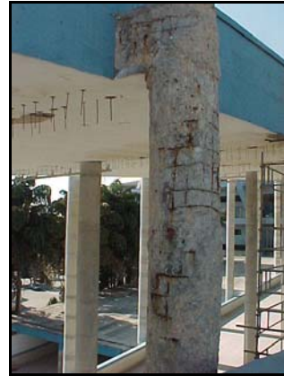
Foto 4: Deterioração na estrutura de pilar de apoio das rampas monumentais
