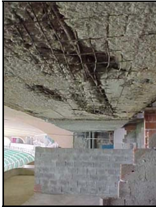
Foto 3: Anomalias no concreto, em laje de cobertura do estádio.
