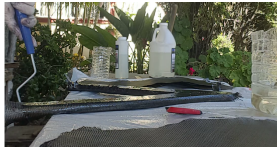
Figura 46. Aplicación de resina epoxica sobre fibra de carbono con rodillo de metal.
