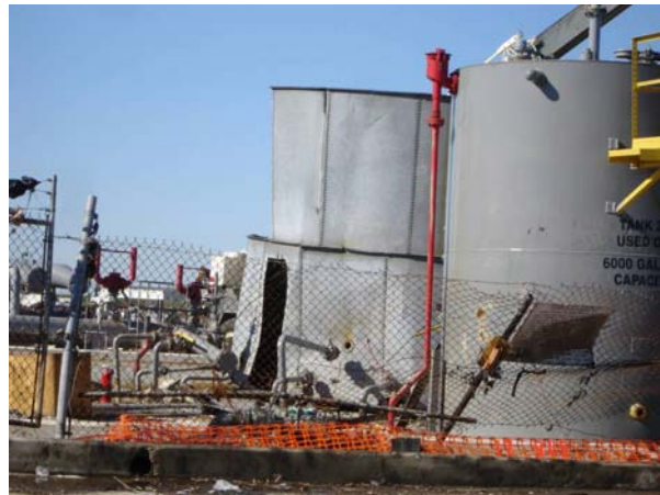
Figura 8: Varios tanques dañados en una planta al norte de Port Sulphur, Louisiana. (Fotografía de los autores, noviembre 17).
