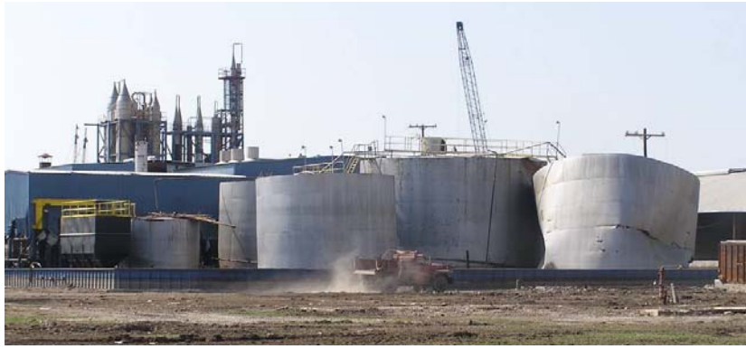
Figura 7: Tanques pandeados en Fish Oil, Port Sulphur, Louisiana. (Fotografía de los autores, octubre 17).
