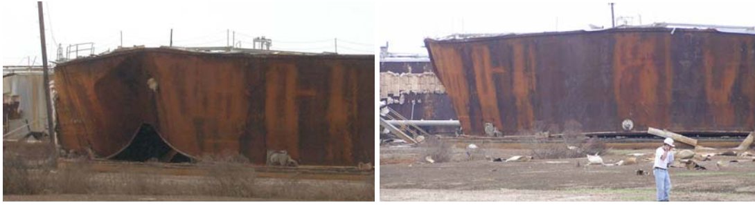
Figura 3: Tanque pandeado en Port Sulphur, Louisiana (Fotografía de los autores, octubre 17).
