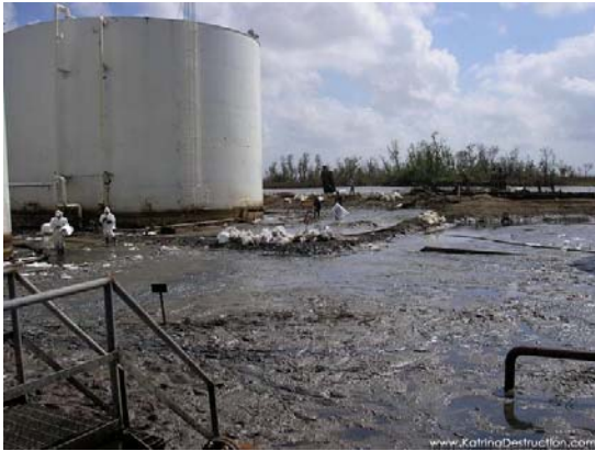
Figura 11a: Planta Dynergy, Venice, Louisiana. Vista de uno de los tanques y del dique de retención lleno de agua de inundación y petróleo de derrame. (Fotografía de USCG).
