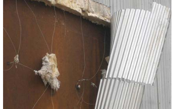
Figura 5: Pérdida del recubrimiento aislante en Port Sulphur, Louisiana. Estos tanques estaban en muy buenas condiciones antes del huracán Katrina. (Fotografía de los autores, octubre 17).
