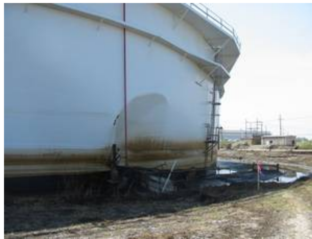
Figura 18b: Detalle de la parte dañada en uno de los tanques mayores en el sector norte de Murphy Meraux Refinery. (Fotografía de EPA).
