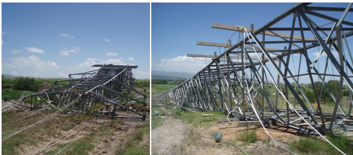
Figura 1: Torres de transmisión dañadas por viento intenso en México.
