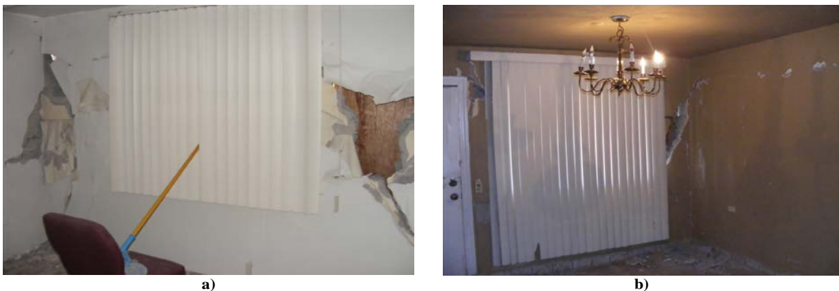
Figura 10: Daño observado en el muro de fachada visto desde el interior de la vivienda.
