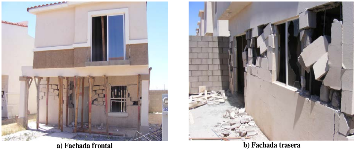
Figura 12: Daño severo (colapso incipiente) observado en la Vivienda A.
