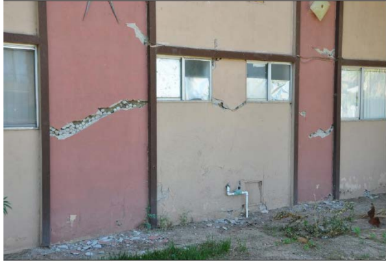
a) Daño en aplanados de yeso
