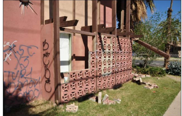
b) Falla de celosía
