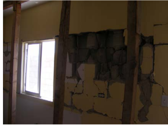
b) Daño en el muro posterior, visto del interior
