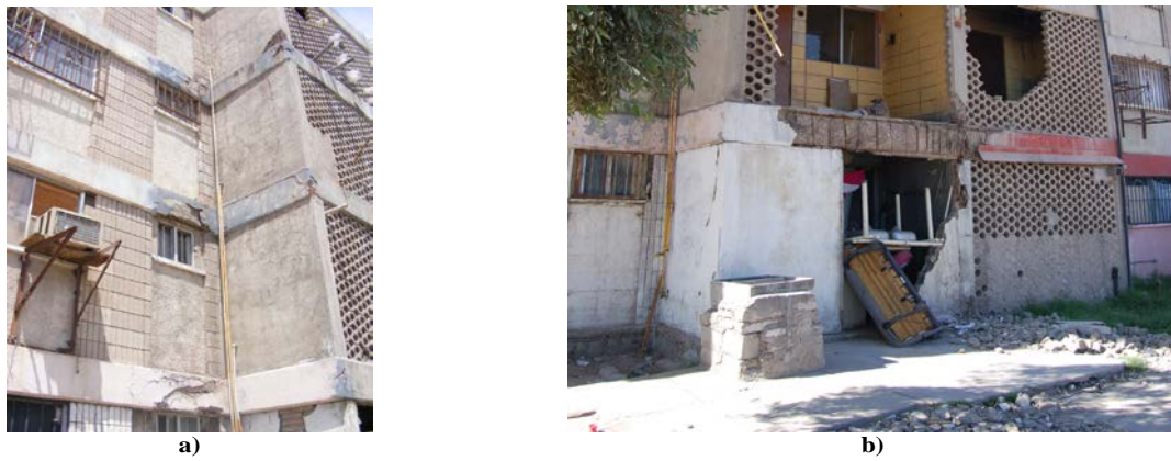
Figura 7: Daño típico observado en traveses y conexiones viga-columna.
