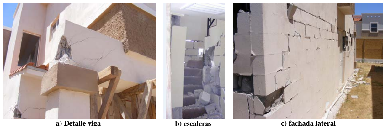
Figura 13: Detalles del daño (colapso incipiente) observado en la Vivienda A.
