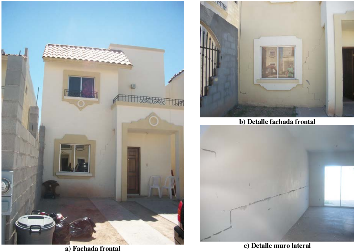
Figura 18: Daño observado en la Vivienda D.
