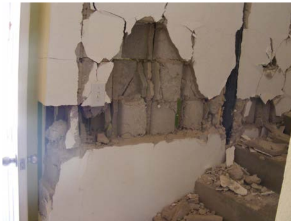
a) Daño en el muro de escaleras
