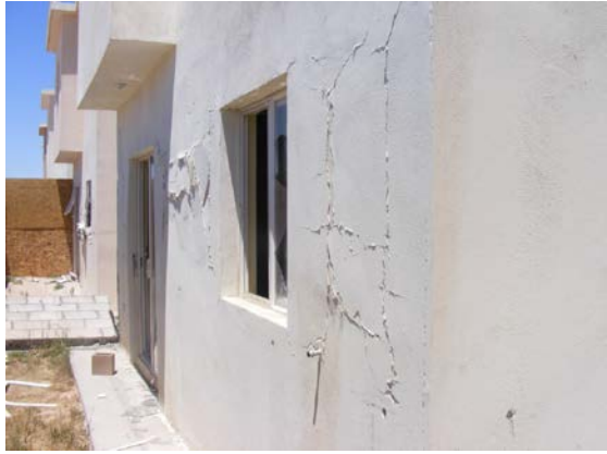
a) Daño en la fachada posterior
