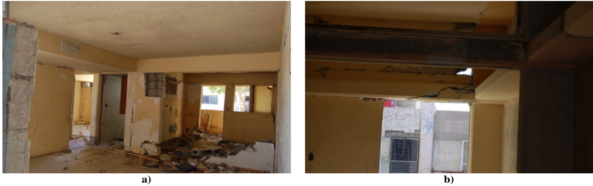
Figura 6: Daño típico observado en el interior de los departamentos.
