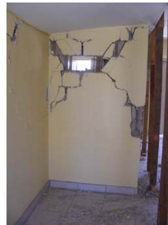
b) Daño en muro interior
