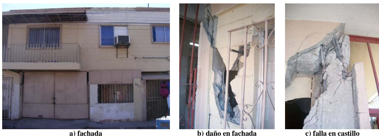
Figura 9: Daños observados en vivienda particular de autoconstrucción de interés medio.
