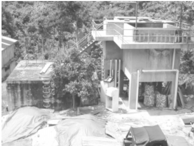
Figura 5: Filtro Lento de Arena (derecha) Adyacente al Tanque de Almacenamiento y Distribución de Agua (izquierda)
