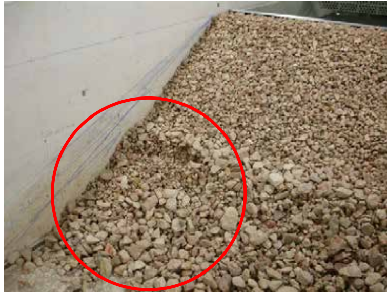
Foto 20. Ejemplo de daño de nivel 3. Caso H_b^*=0,4 ; N_b=1,5 .
